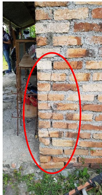
Grietas en muros de mampostería en la parte externa de la vivienda.
