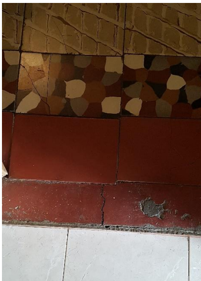
Hundimiento del suelo y cuarteado de las baldosas, (habitación).
