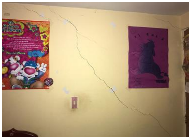
Grietas en las habitaciones del segundo piso
