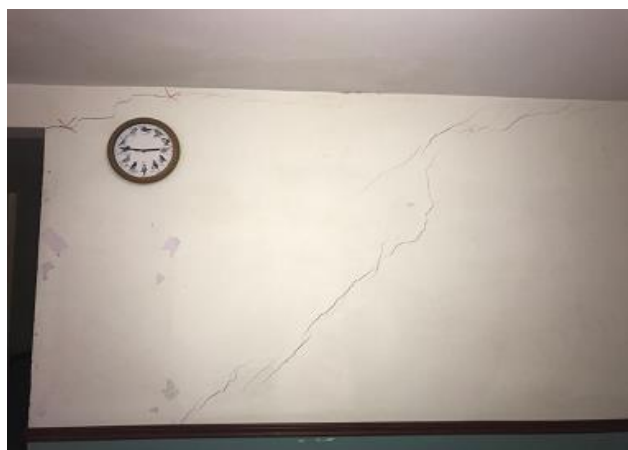
Grietas en las habitaciones del segundo piso
