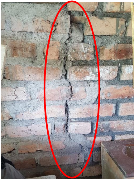
Grietas en muros de mampostería en la parte externa de la vivienda.
