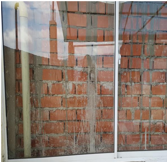
Ventana bloqueada producto de la salpicadura de cemento.
