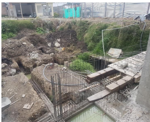
Excavaciones para cimentación, algunos pilotes fundidos y otros solo con acero de refuerzo, en general con presencia de nivel freático (presencia de agua)
