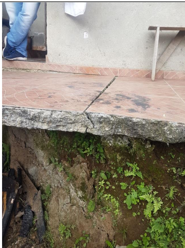
Fisuras y grietas ocasionadas por el movimiento de tierras, generados por las crecientes de la quebrada
