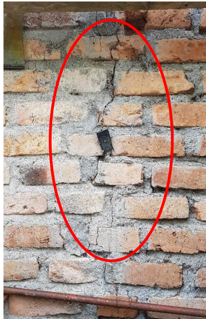
Grietas en muros de mampostería en la parte externa de la vivienda.
