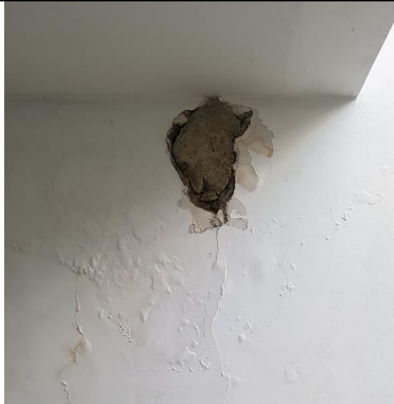
Humedad y deterioro de la pared.
