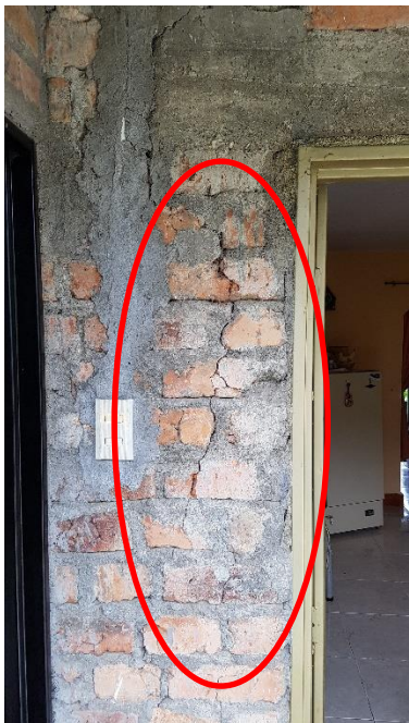
Grietas en muros de mampostería en la parte externa de la vivienda.
