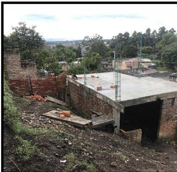
Imagen 40. Parte frontal de la construcción, donde se ven problemas constructivos, además de la escorrentía que perjudica a las viviendas colindantes, fuente propia.
