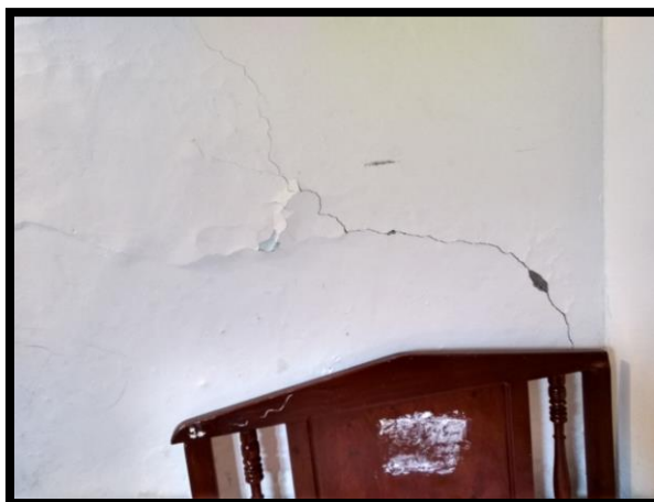
Imagen 52. Grietas transversales en paredes, fuente propia.
