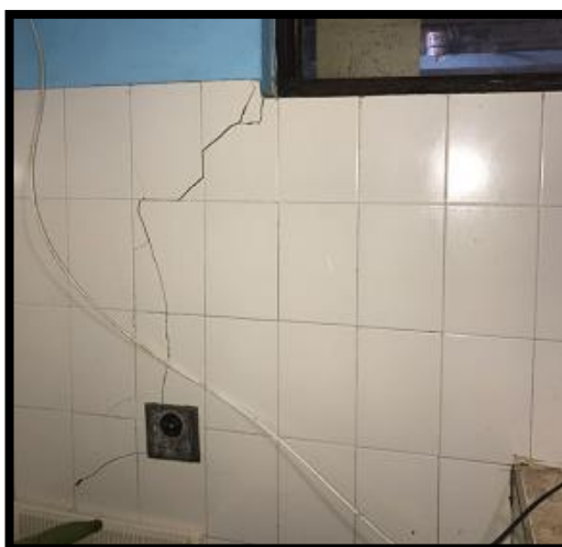
Imagen 26. Fisuras en el enchape de la cocina, fuente propia.
