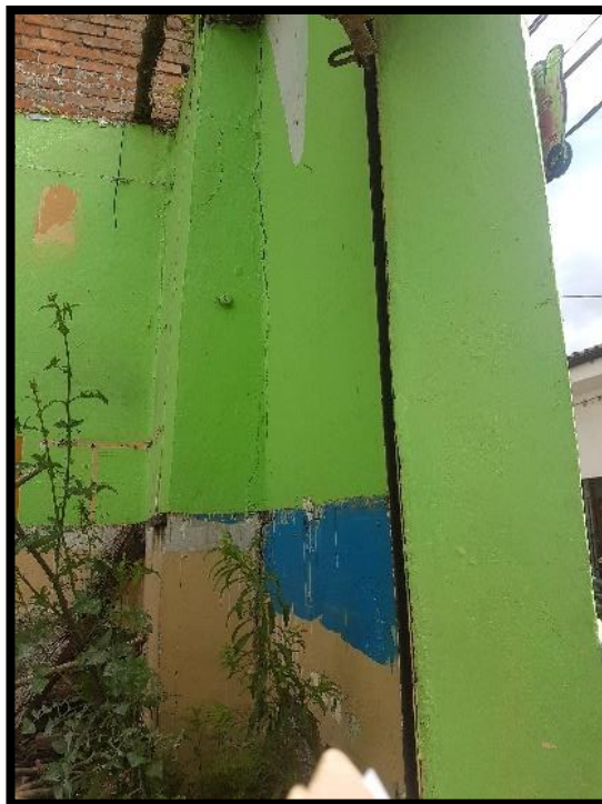
Imagen 81. Grieta longitudinal en muro de Tapia Pisada, fuente propia.
