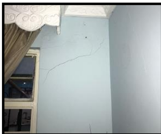
Imagen 25. Grietas en las habitaciones del primer piso, fuente propia.
