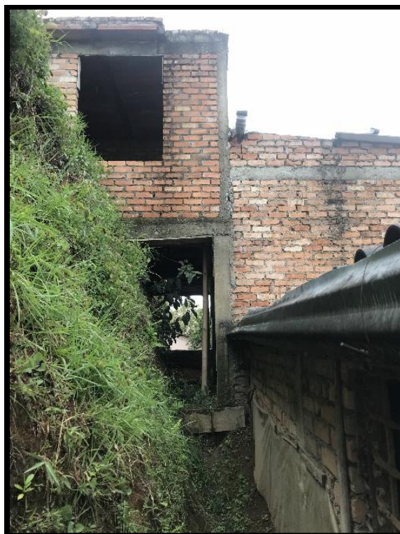
Imagen 39. Parte colindante de la construcción con las viviendas afectadas, fuente propia.
