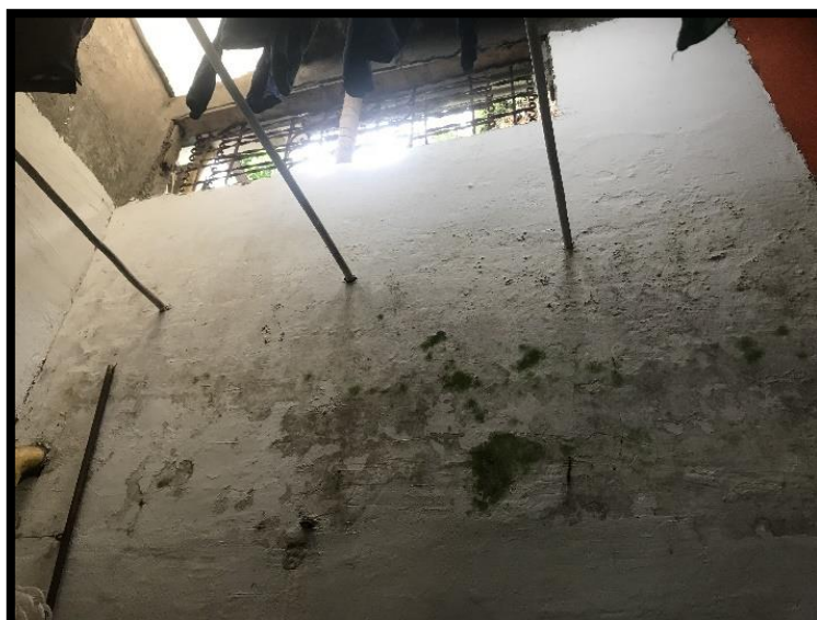
Imagen 37. Humedad presente en la casa del señor Israel Cerón Urbano, ocasionada por la construcción que se está realizando en la parte posterior a la vivienda, fuente propia.
