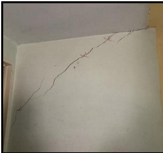
Imagen 27. Grietas en las habitaciones del segundo piso, fuente propia.
