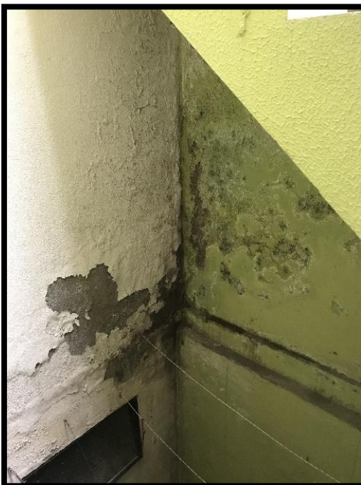
Imagen 36. Humedad presente en la casa del señor Jaime Ernesto Narváez, debido a la construcción que se está realizando en la parte trasera a la vivienda, fuente propia.
