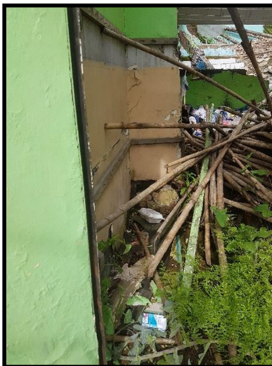
Imagen 78. Falla cortante en la base del muro, fuente propia.
