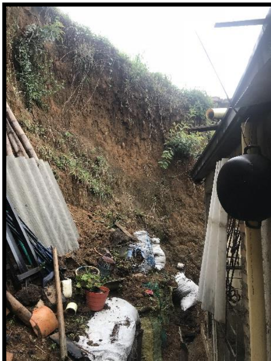
Imagen 38. Parte posterior de la vivienda de la señora Bertha Sotelo Cerón, que colinda con un talud, el cual se encuentra debilitado debido a la escorrentía que genera la construcción, fuente propia.
