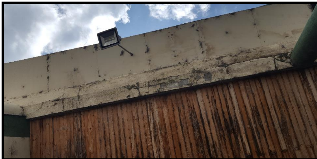
Imagen 59. Deterioro de elementos estructurales como vigas, fuente propia.
