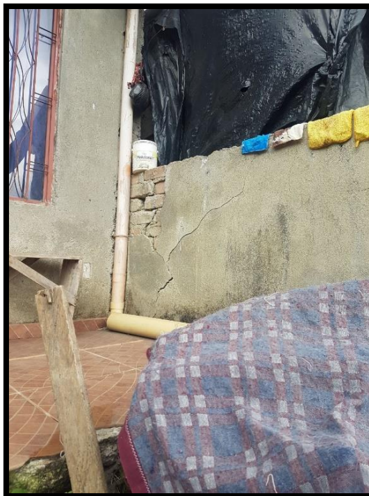
Imagen 21. Muros damnificados producto de la erosión de los taludes ubicados en la margen del cauce. El muro está a punto de colapsar, fuente propia.
