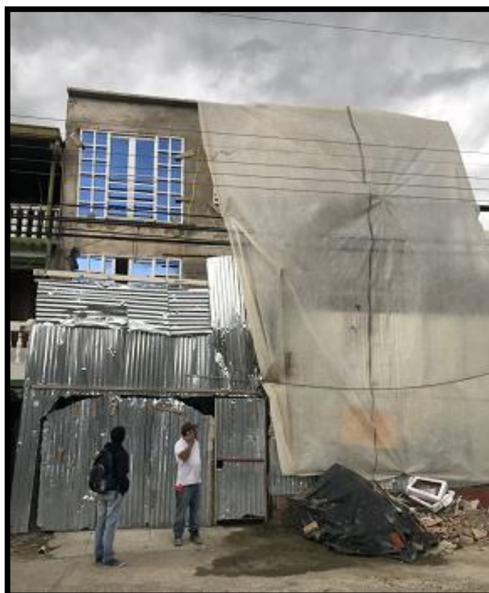
Imagen 30. Construcción de vivienda multifamiliar de 4 pisos, sin licencia de construcción, fuente propia.
