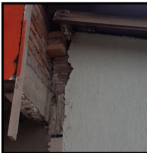
Imagen 51. Falta del respectivo aislamiento entre la edificación y la vivienda, fuente propia.
