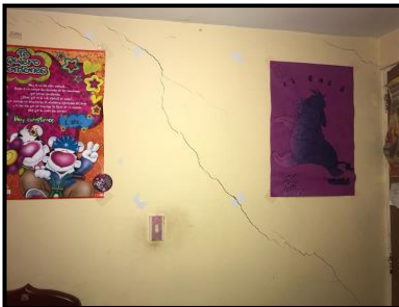
Imagen 29. Grietas en las habitaciones del segundo piso, fuente propia.
