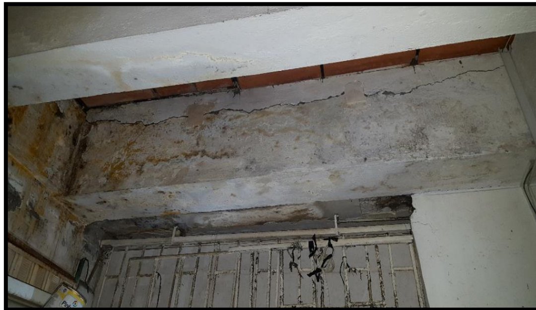
Imagen 61. Presencia de grietas y humedad en vigas del sótano, fuente propia.
