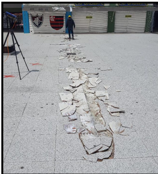
Imagen 58. Levantamiento y fractura de los pisos de cerámica del patio interior, fuente propia.
