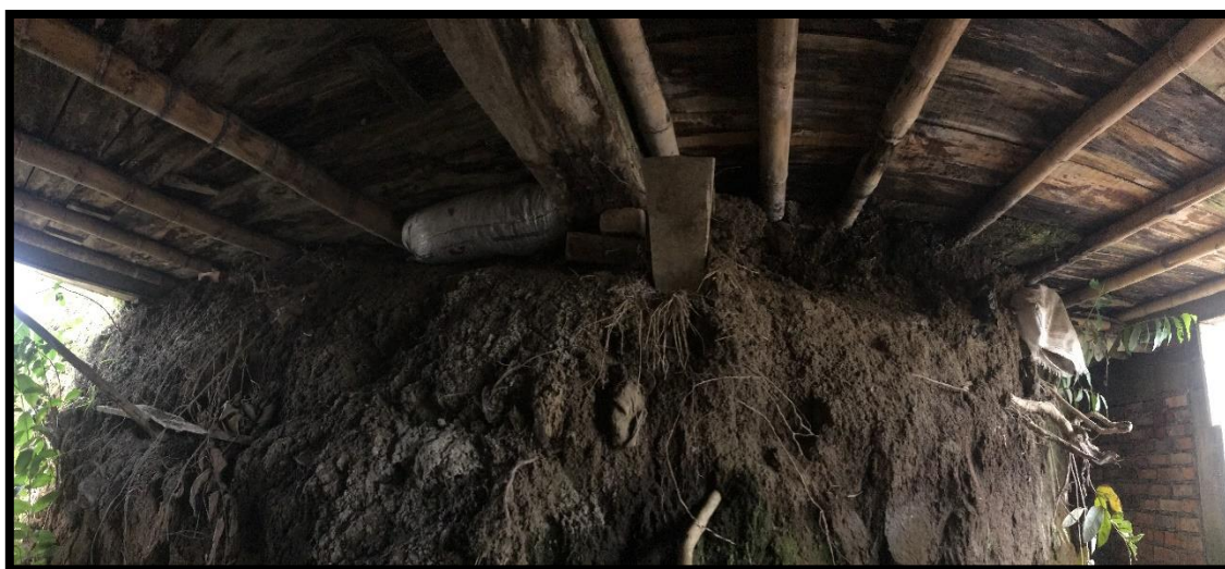
Imagen 35. Losa de piso apoyada en tablas madera, y costales de arena, sobre el talud de tierra orgánica, fuente propia.
