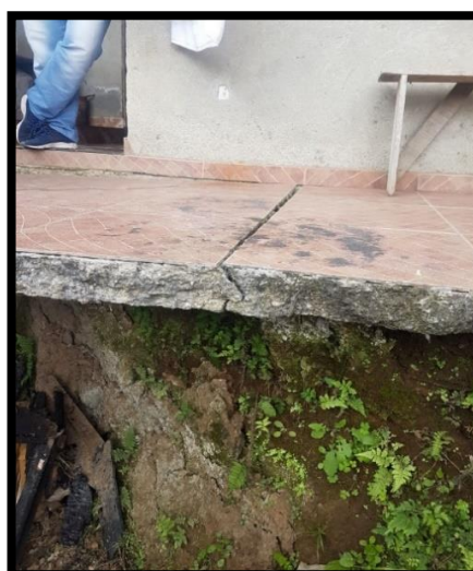
Imagen 20. Fisuras y grietas ocasionadas por la erosión de los taludes ubicados en la margen del cauce, fuente propia.
