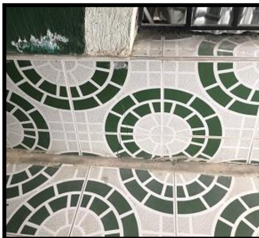
Imagen 24. Presencia fisuras en las baldosas del antejardín, fuente propia.
