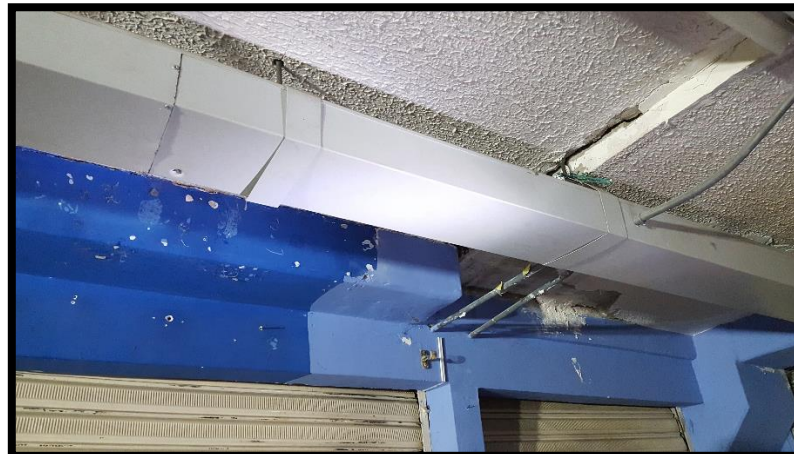
Imagen 64. Discontinuidad en vigas, fuente propia.
