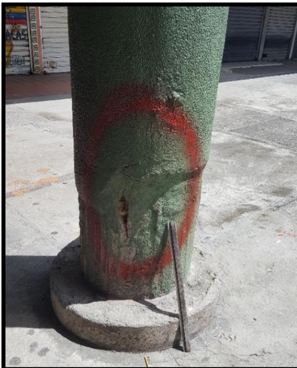
Imagen 60. Deterioro en elementos estructurales como columnas, fuente propia.
