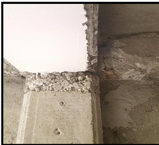
Imagen 33. Hormigqueo en el concreto y segregación del agregado en los nudos entre vigas y columnas, fuente propia.
