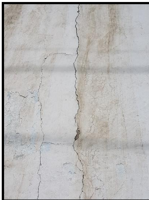
Imagen 80. Grietas longitudinales en muro de Tapia Pisada, fuente propia.
