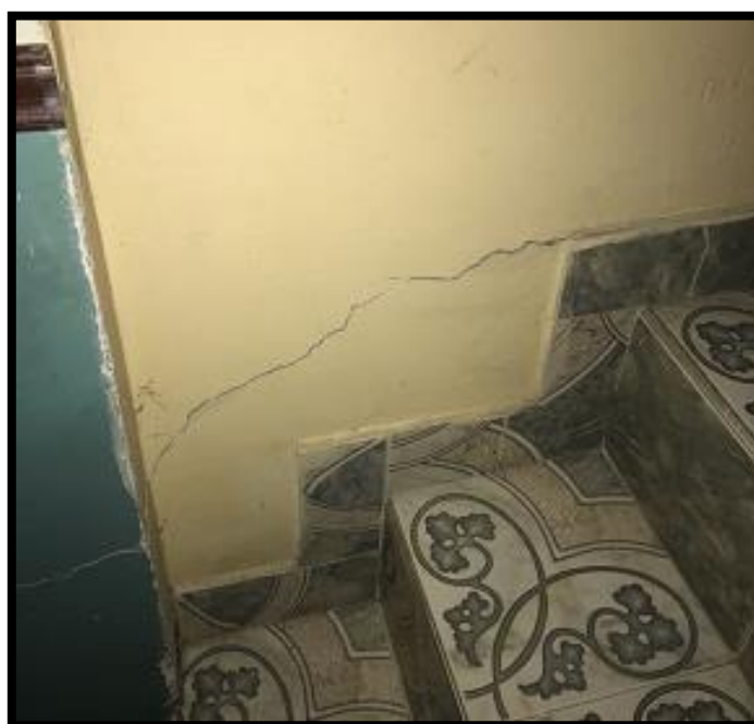
Imagen 28. Grietas en los muros de las escaleras, fuente propia.
