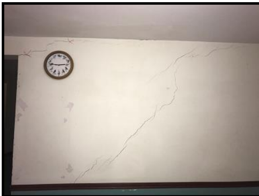
Imagen 31. Grietas en las habitaciones del segundo piso, fuente propia.
