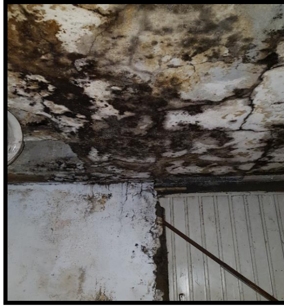
Imagen 62. Humedades y filtraciones en la losa de la edificación, fuente propia.
