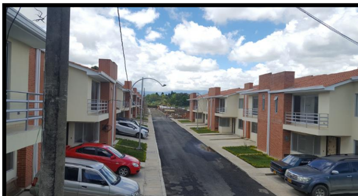
Imagen 68. Viviendas tipo 1, parte se encuentran en etapa de acabados, y otras en etapa de construcción, fuente propia.
