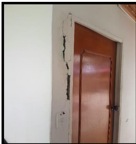
Imagen 50. Grietas longitudinales en paredes, fuente propia.
