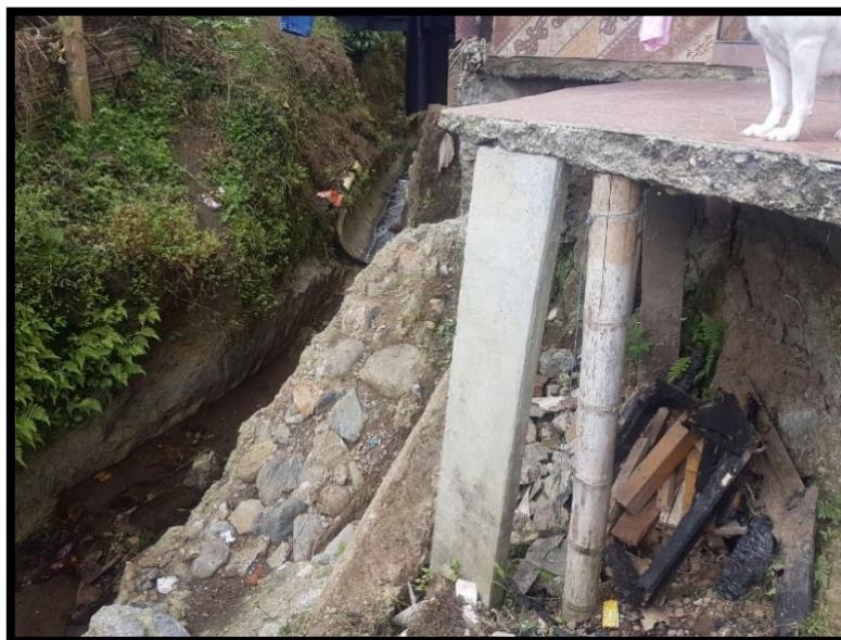
Imagen 22. Medidas de estabilización realizadas por los habitantes de la vivienda para evitar el colapso de la losa que esta flotando, fuente propia.
