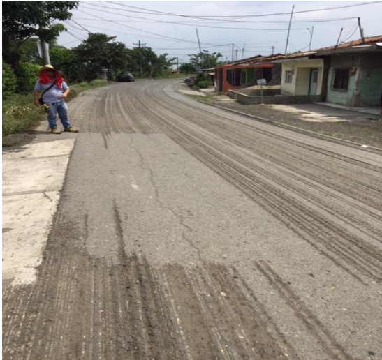
Fotografía 5. Material no retirado, problemas con la fresadora
