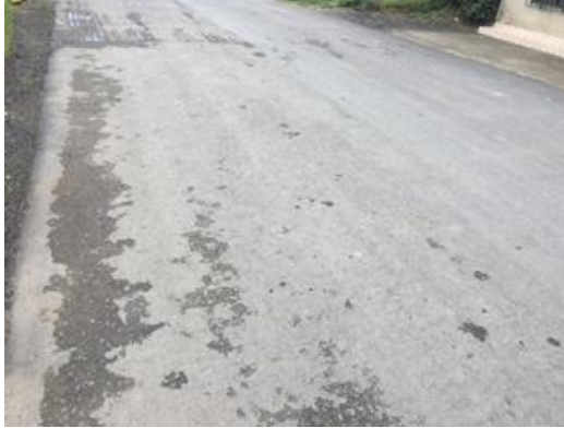
Fotografía 53. Agregados expuestos en el pavimento
