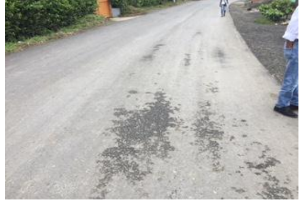
Fotografía 64. Agregados expuestos en el pavimento
