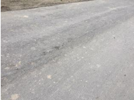
Fotografía 97. Montículos longitudinales de asfalto
