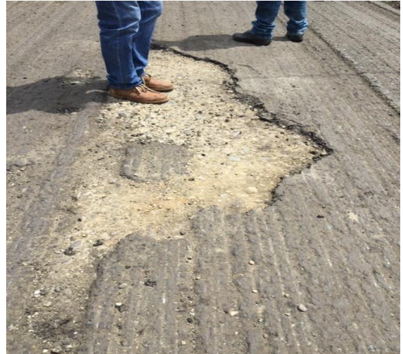
Fotografía 6. Desnivel en pavimento
