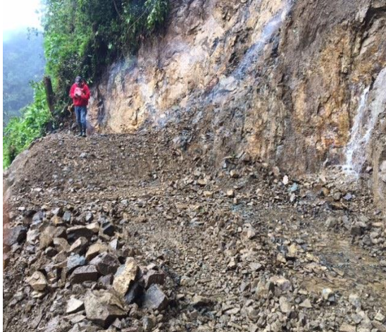
Fotografía 67. Material rocoso desprendido del talud
