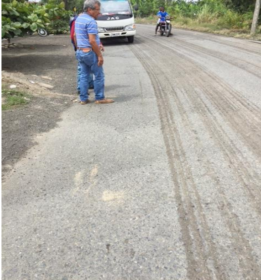
Fotografía 7. Vista pavimento fresado
