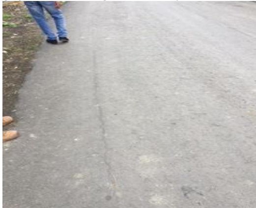
Fotografía 75. Grieta longitudinal sobre pavimento
