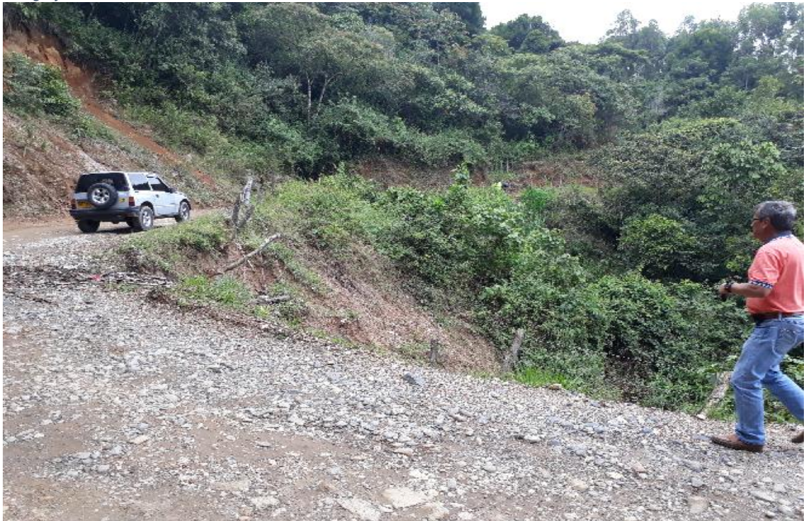
Fotografía 34. Sitio crítico k2+300-k2+500
