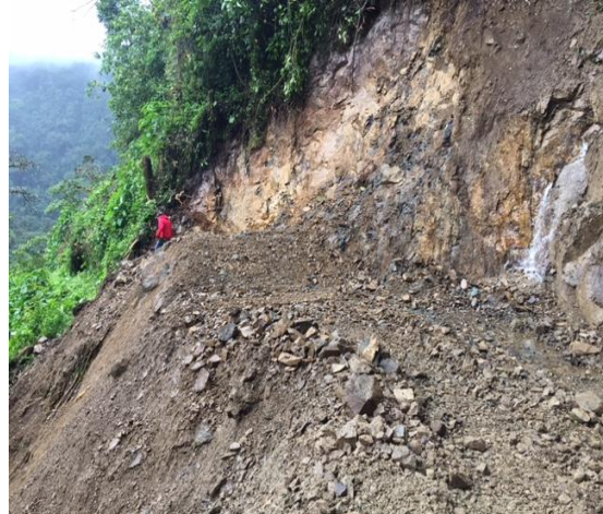
Fotografía 68. Material rocoso desprendido del talud
