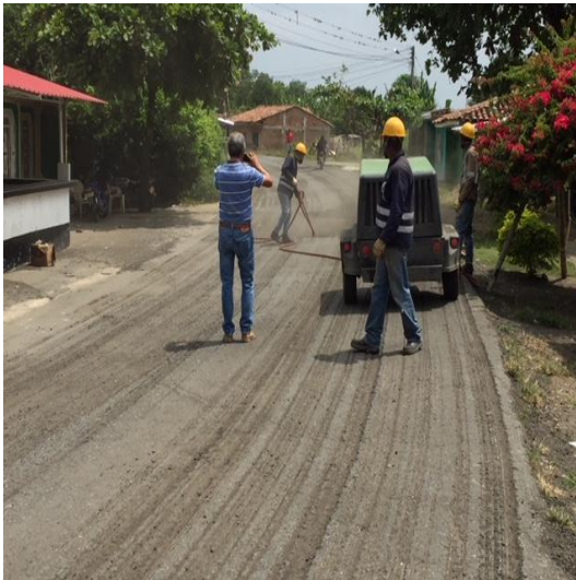
Fotografía 9. Vista pavimento fresado
