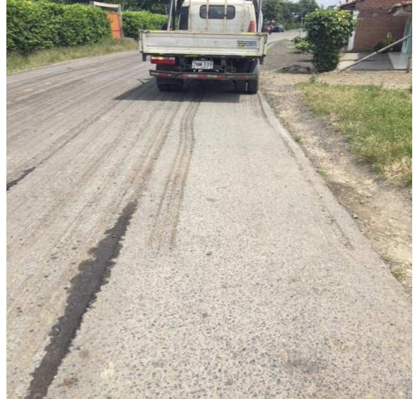
Fotografía 4. Vista pavimento fresado
