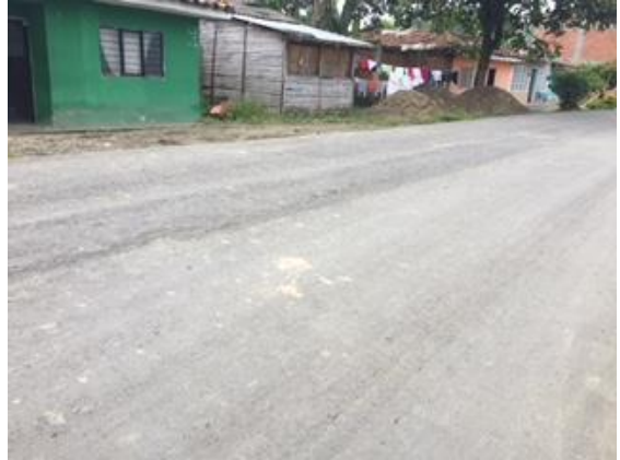
Fotografía 108. Montículos longitudinales de asfalto
