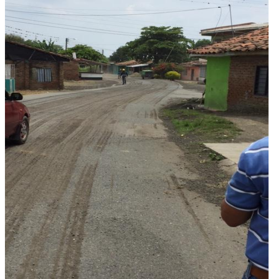
Fotografía 8. Vista pavimento fresado
