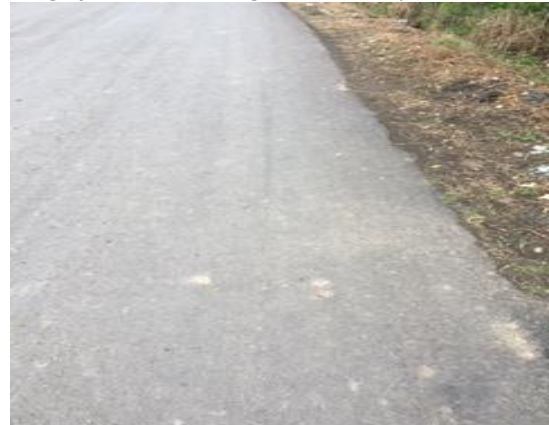
Fotografía 86. Grieta longitudinal sobre pavimento
