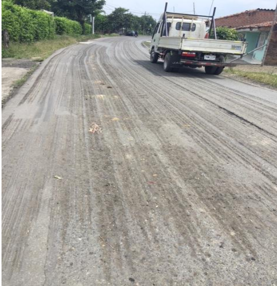
Fotografía 3. Vista pavimento fresado
