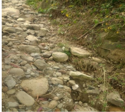
Fotografía 16. Cuneta en vía Vereda Tacueyo
