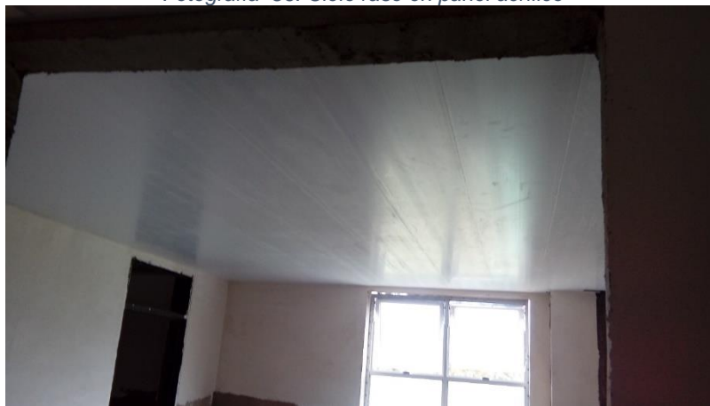
Fotografía 86. Cielo raso en panel acrílico
