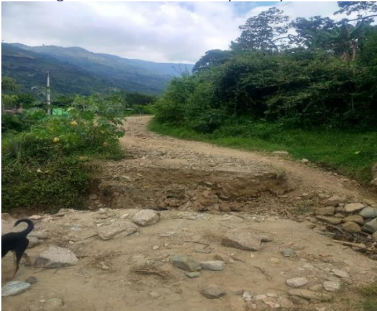
Fotografía 17. Daño de vía por la quebrada
