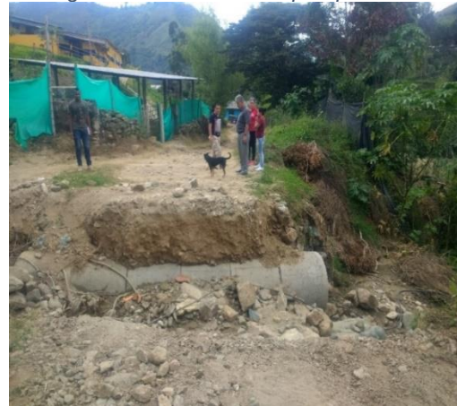
Fotografía 20. Daño de vía por quebrada
