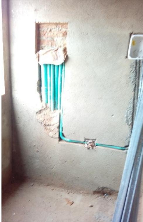
Fotografía 87. Punto de instalación eléctrica
