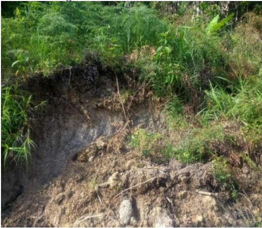
Fotografía 5. Derrumbe sobre vía
