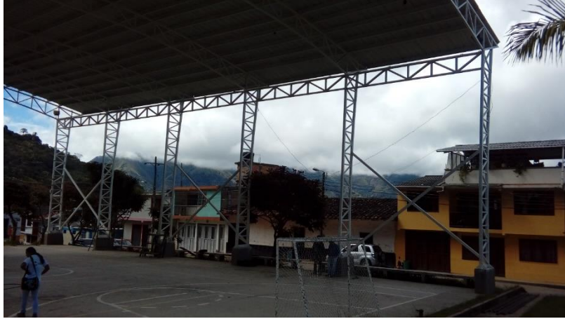
Fotografía 92. Columnas en cercha metálica con pandeo lateral
