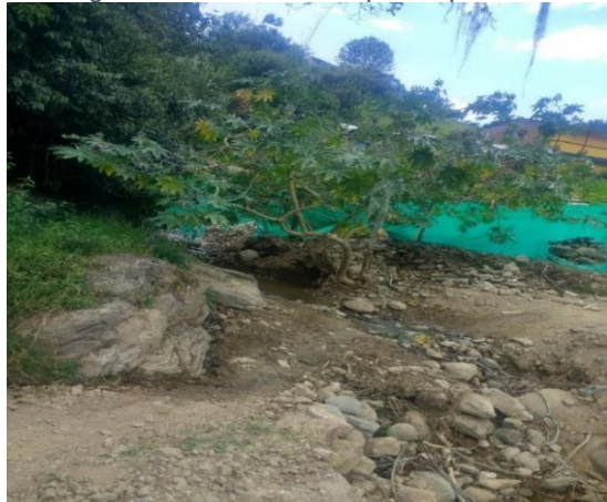
Fotografía 19. Daño de vía por la quebrada
