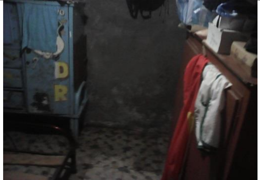
Imagen 6.2.4 HUMEDAD CASA EN LA VEGA
