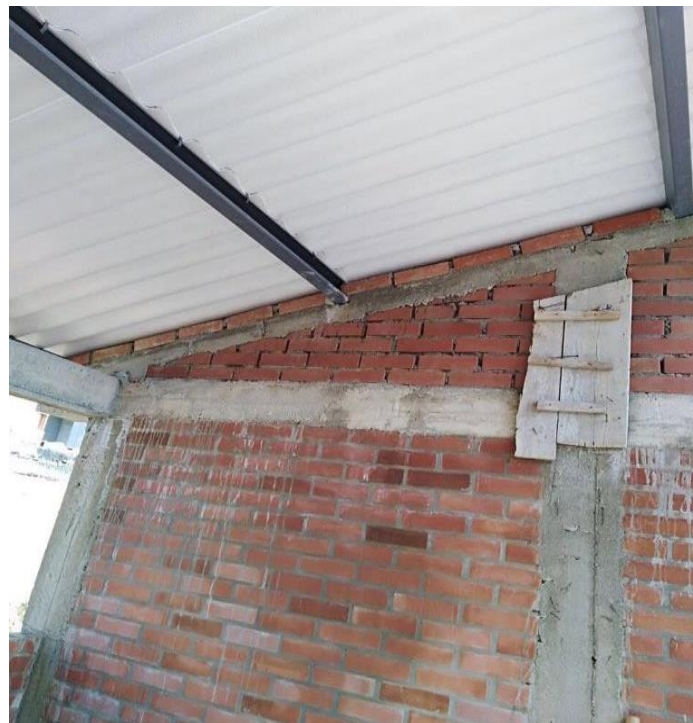
Figura 72: Malos acabados en vigas y columnas – manchas de mortero
