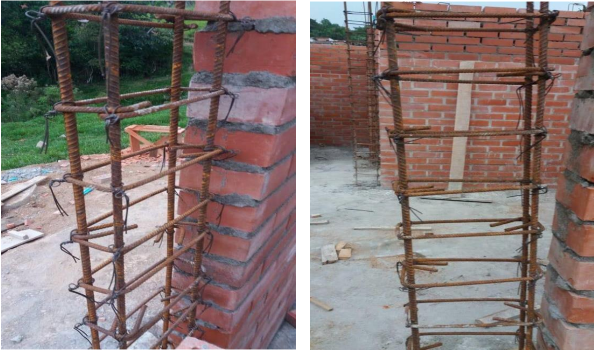
Figura 9 y 10: Corrección de la rotación en los ganchos de acero de refuerzo transversal
