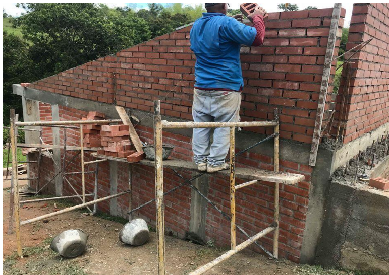
Figura 15: Seguridad industrial nula en la cuadrilla de trabajadores
