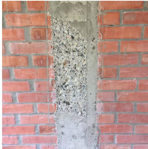
Figura 71: Segregación en columnas
