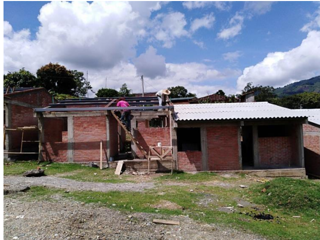
Figura 68: Seguridad industrial nula en la cuadrilla de trabajadores
