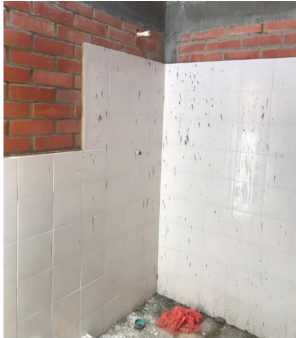
Figura 64: Enchape de baño con manchas de mortero
