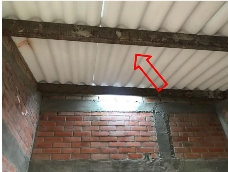
Figura 59: Perlin con posible oxidación- sin anticorrosivo
