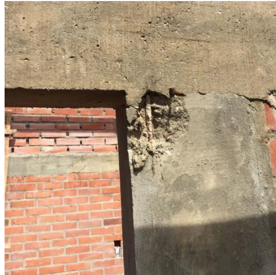
Figura 44: Acero de refuerzo expuesto
