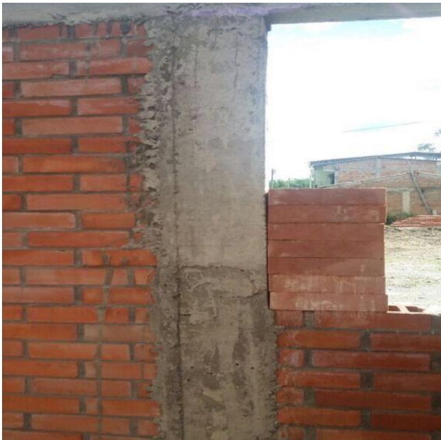
Figura 40: Encofrado inadecuado en columnas
