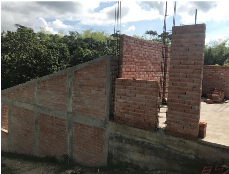
Figura 37: Retraso en la instalación de cubierta
