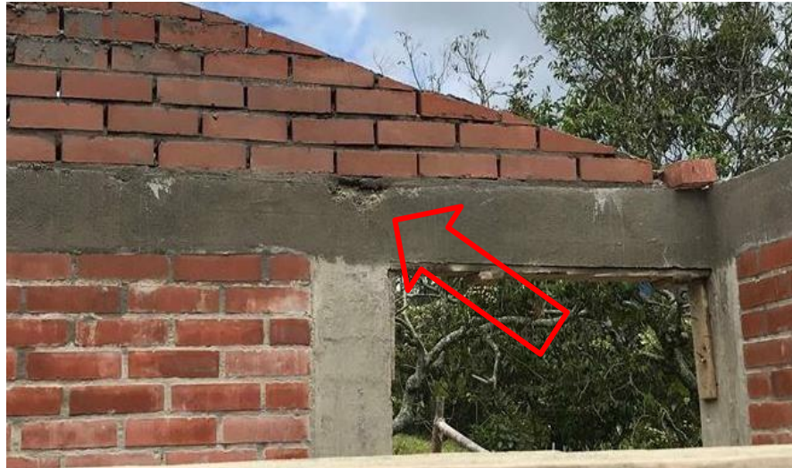
Figura 19: Malos acabados en la viga de amarre
