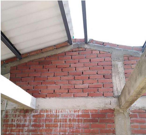
Figura 38: Mampostería manchada con mortero de pega
