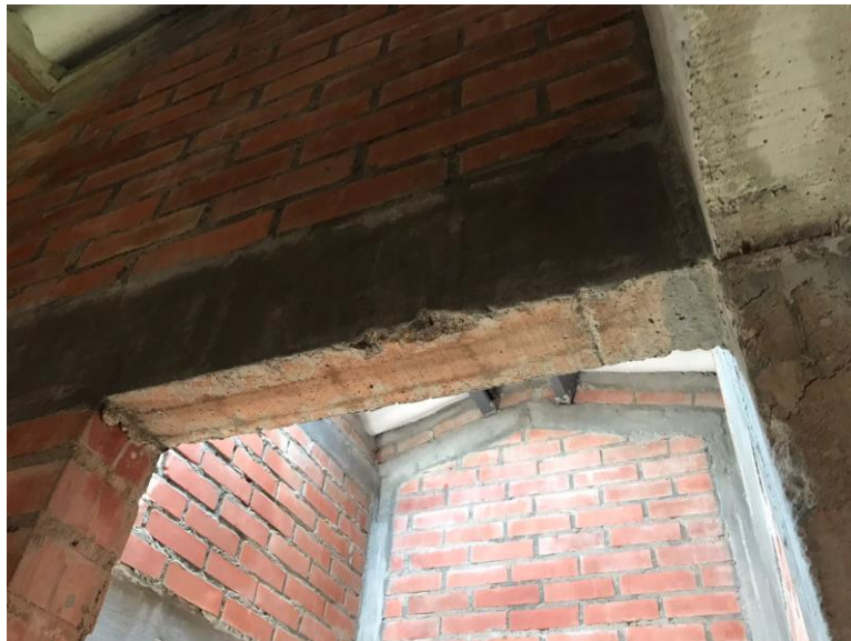
Figura 65, 66 y 67: Columnas y vigas de amarre con malos acabados
