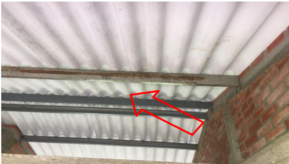
Figura 42: Perlines sin anticorrosivo
