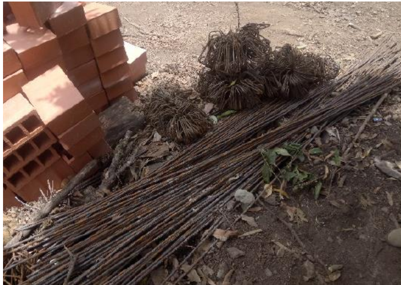
Figura 25: Mal almacenamiento de aceros expuestos al aire libre con posible oxidación
