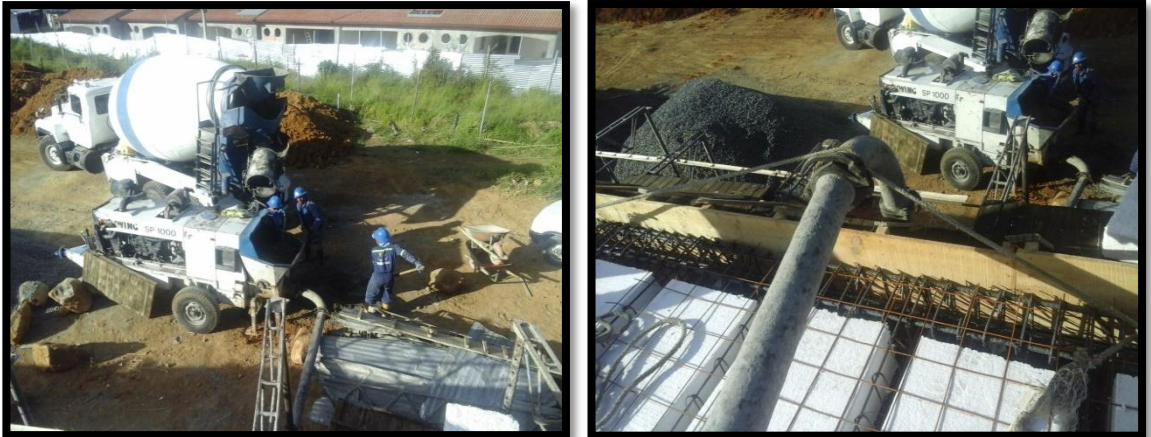
Figuras 14. Camión transportador de concreto y bomba que impulsa el concreto. Tubería transportadora de concreto.
