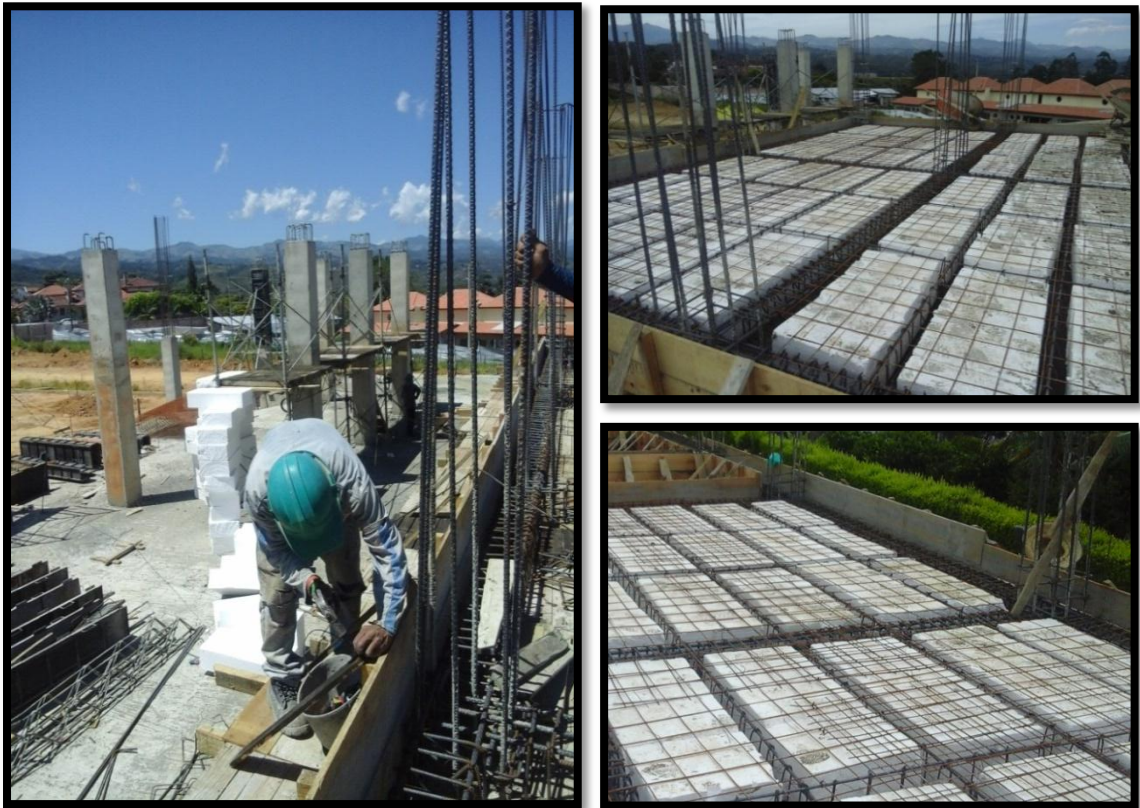
Figura 38. Formaleta alrededor de la losa y la colocación de mallas electro soldadas.
