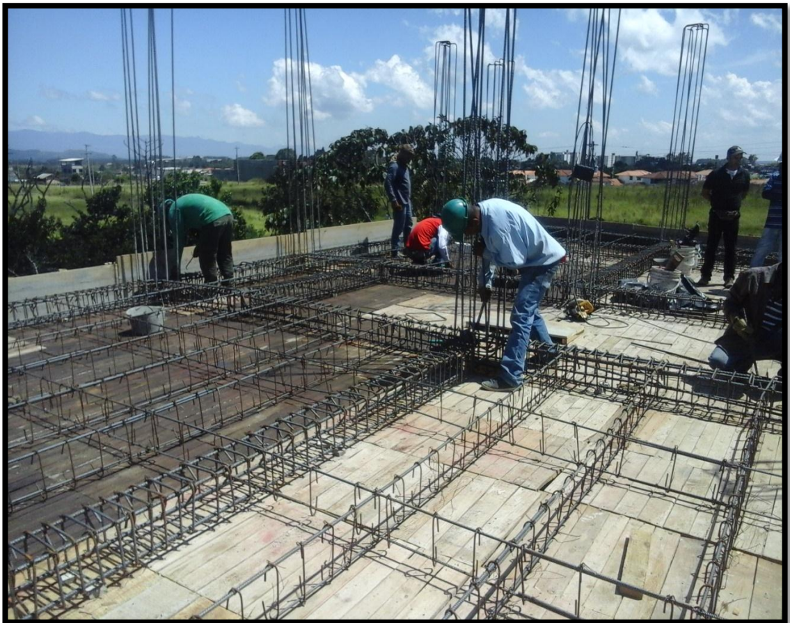
Figura 35. Armadura de vigas amarradas a columnas que vienen de planta uno con colocación de estribos de diseño a distancias calculadas.
