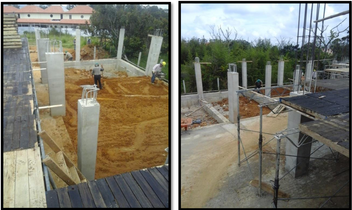
Figura 7. Zona sin tableros
