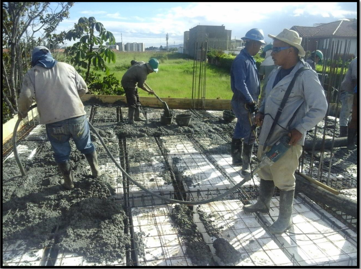
Figura 18. Personal encargado de la vibración del concreto para el mejor acomodo de la mezcla.
