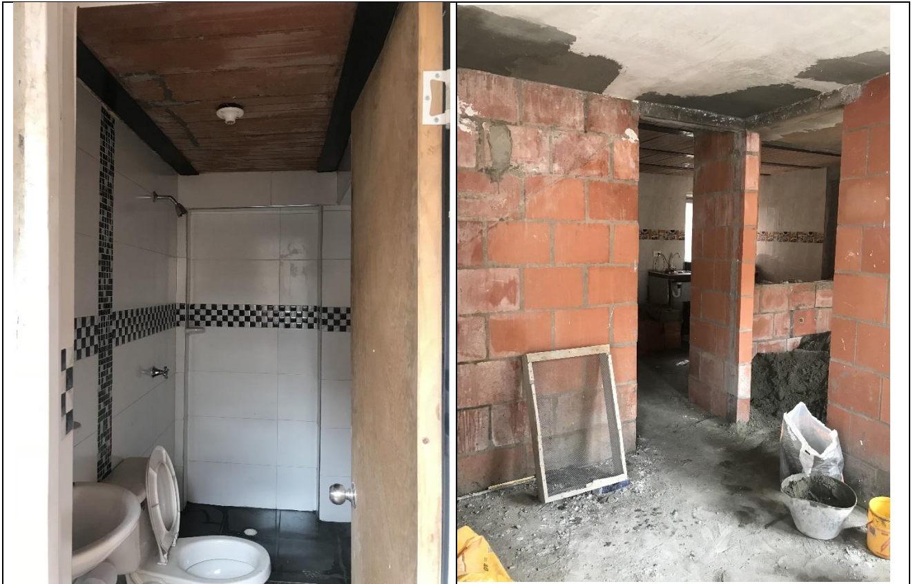
Ampliación de un baño en primer piso Reparaciones locativas en la primera planta
