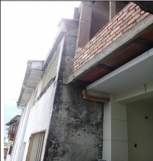
Se evidencia humedad en los muros colindantes a la construcción
