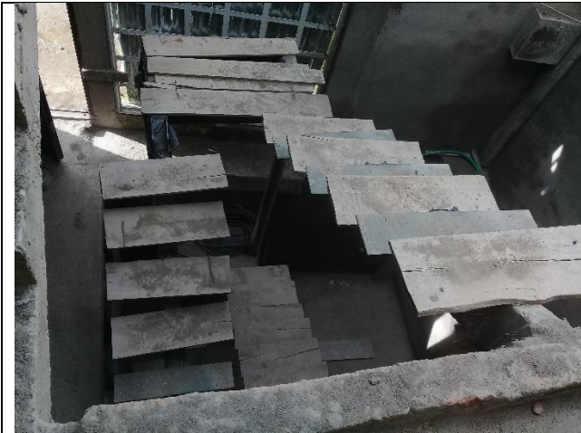
Escalera provisional con tablas de madera como escalones sin seguridad alguna
