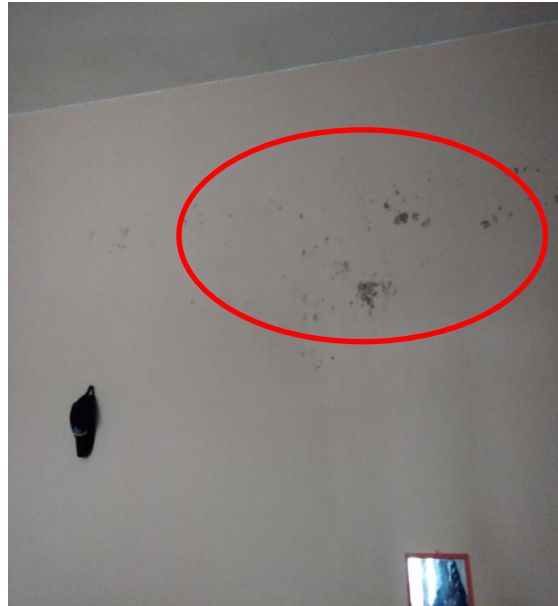
Figura 6.3.2.1. Humedad en una de las paredes.
