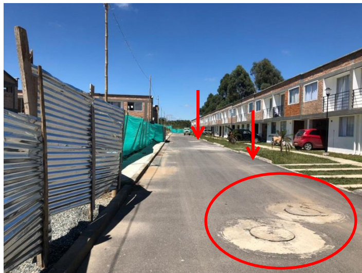
Figura 6.9.2.4. Cámaras de recolección y lugar donde deberían ir los sumideros faltantes.
