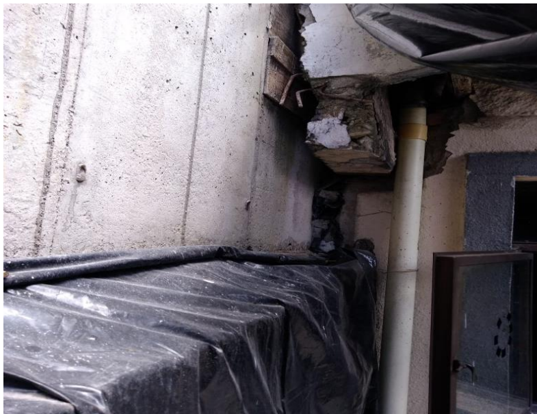
Figura 6.8.2.1. Daños sobre canales ocasionados por la construcción.
