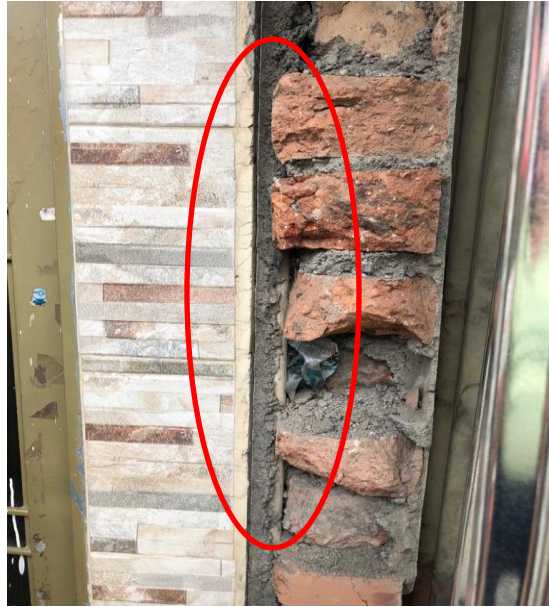
Figura 6.2.2.3. La construcción nueva no tuvo en cuenta la separación sísmica mínima.
