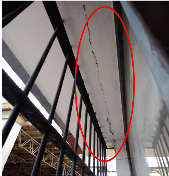
Figura 6.3.2.3. Fisuras en una de las paredes colindantes.
