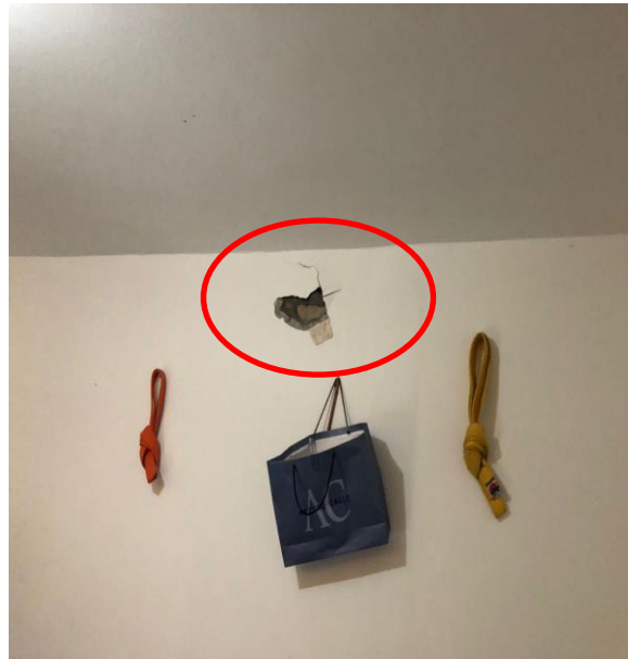
Figura 6.2.2.1. Agujero en una de las paredes colindantes con el predio donde se realiza la obra nueva.
