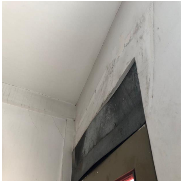
Figura 6.2.2.2. Humedad que se presenta debido a la construcción.
