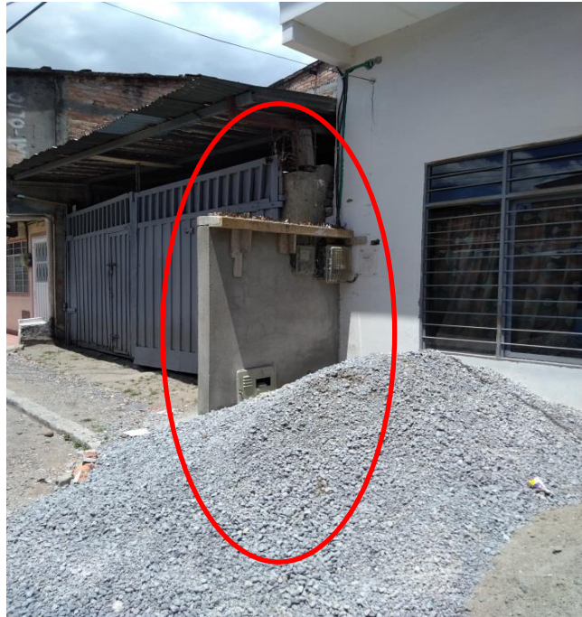
Figura 6.10.2.1. Muro y escombros invadiendo el andén.
