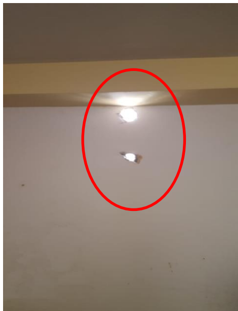
Figura. 6.1.2.3. Agujeros en la pared colindante y aparentemente medianera.
