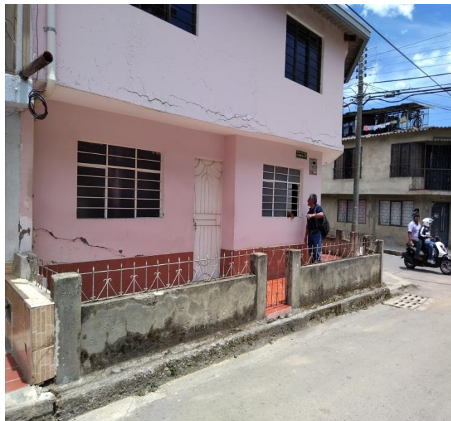
Figura 6.10.2.4. Cerramiento en muros y columnetas las cuales invaden el andén.
