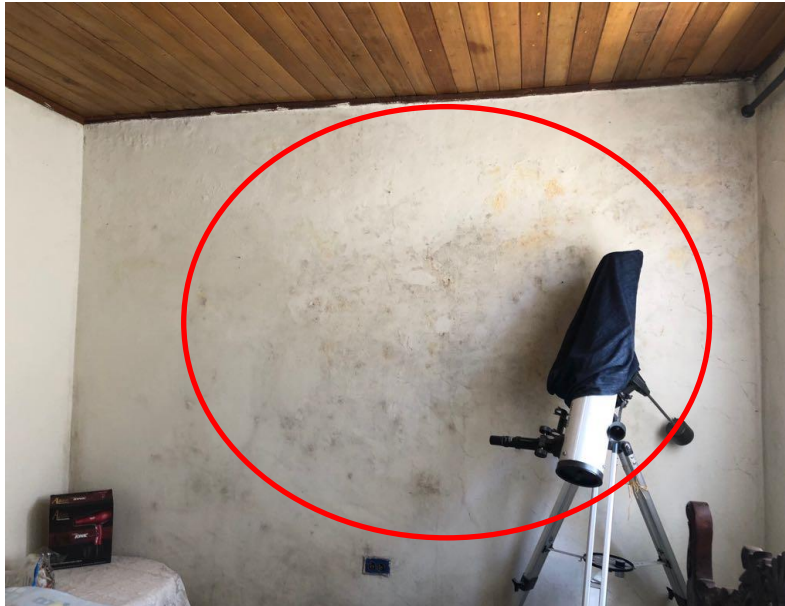
Figura 6.8.2.2. Muros afectados por la humedad.
