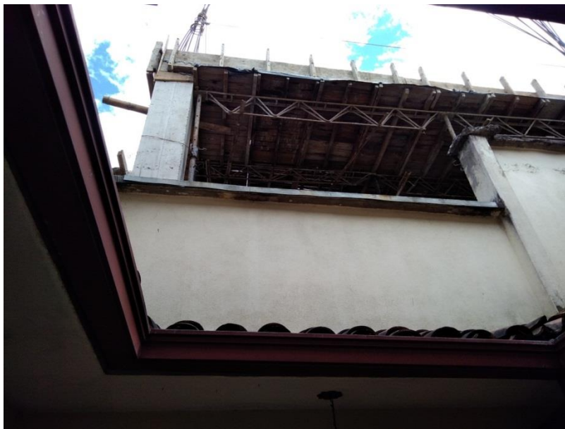
Figura 6.3.2.4. No existe ninguna red de protección para con los otros domicilios colindantes.
