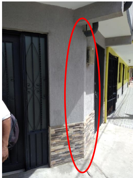
Figura 6.6.2.2. Lugar donde debería ir la columna no construida.
