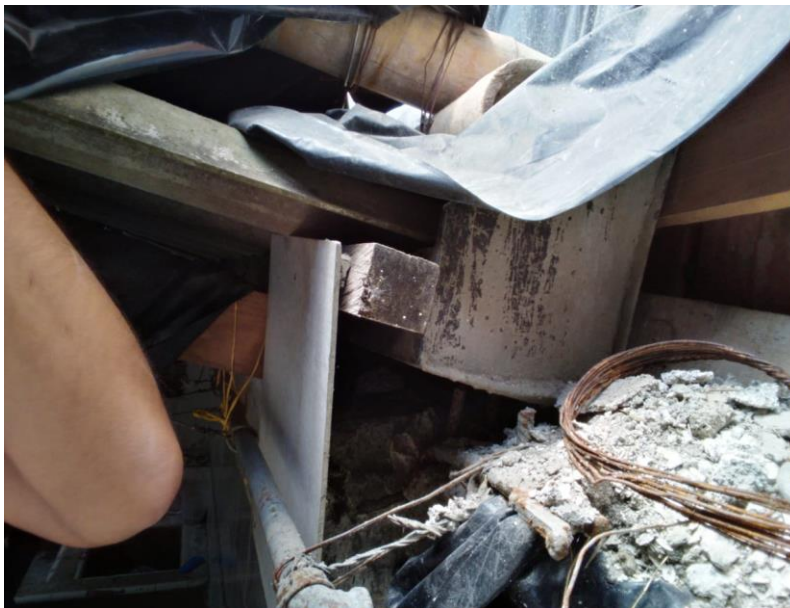
Figura 6.8.2.3. Escombros sobre la vivienda.
