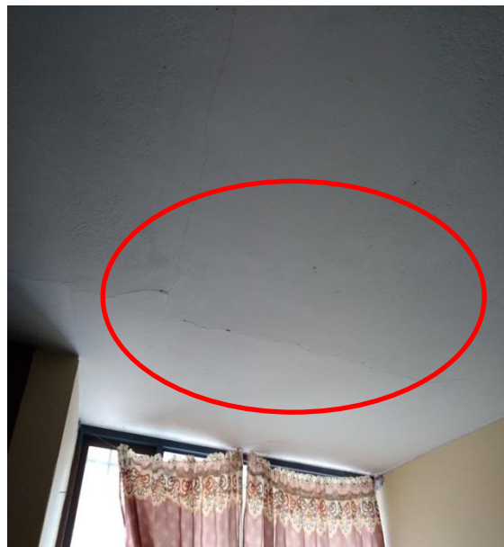
Figura 6.3.2.2. Fisuras en el cielo raso.
