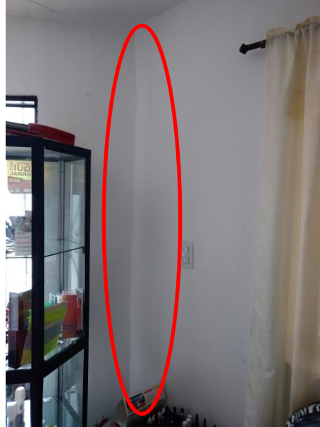
Figura 6.6.2.3. Lugar donde debería ir la columna no construida.
