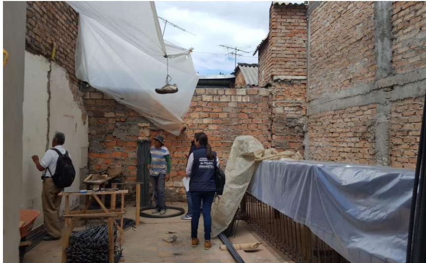
Figura. 6.1.2.4. La obra se encuentra en elaboración de flejes y amarre de varillas.
