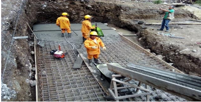
Figura 60. Detalle de la fundición de la losa inferior en el apoyo de la margen izquierda.
