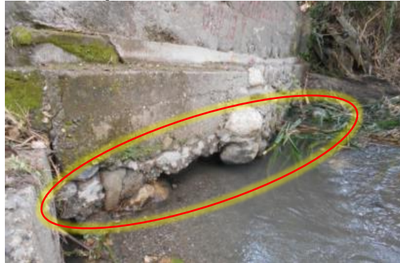
Figura 82. Detalle de socavación en el apoyo de la margen derecha de la quebrada Las Cañas
