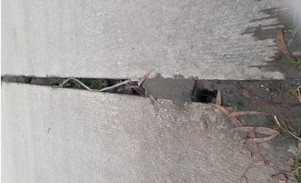
Figura 30. Detalle de separación de junta transversal PR 70+500
