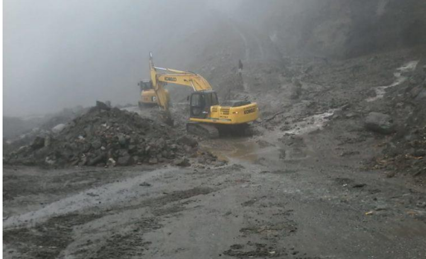
Figura 28. Detalle de atención por parte del contratista de deslizamiento en el PR 70+600.
