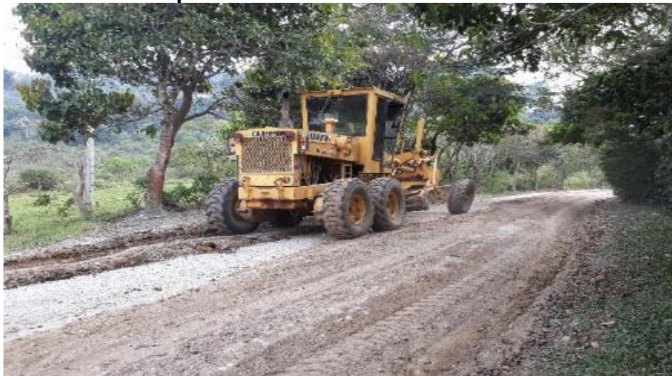
Figura 47. Detalle de perfilación de cunetas en la ruta 26CC07 en el PR 35
