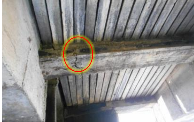
Figura 79. Detalle de grieta en riostra del puente Las cañas
