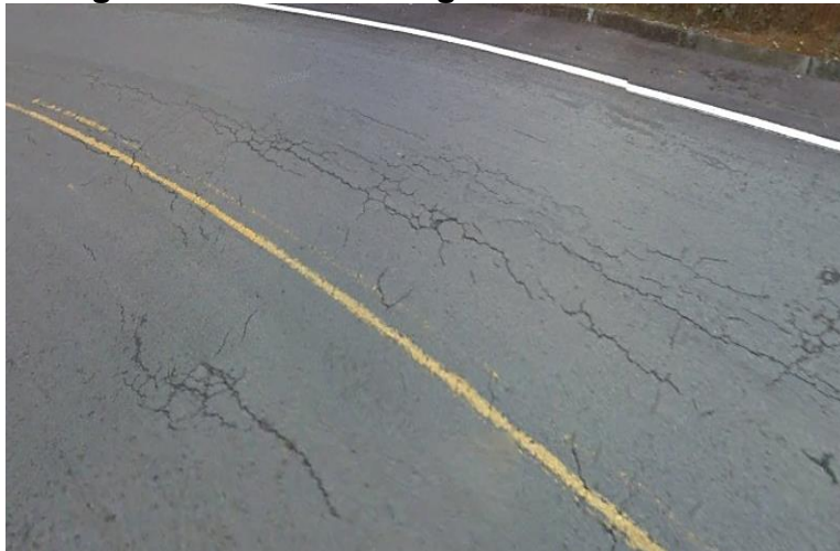
Figura 11. Fisuras Longitudinales Ruta 2602
