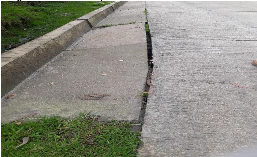
Figura 31. Detalle de separación de cuneta-calzada PR 70+400
