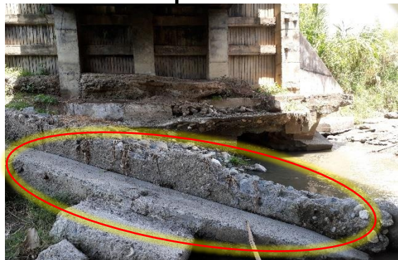
Figura 81. Detalle de desprendimiento de la aleta del estribo de la margen derecha del puente Las Cañas
