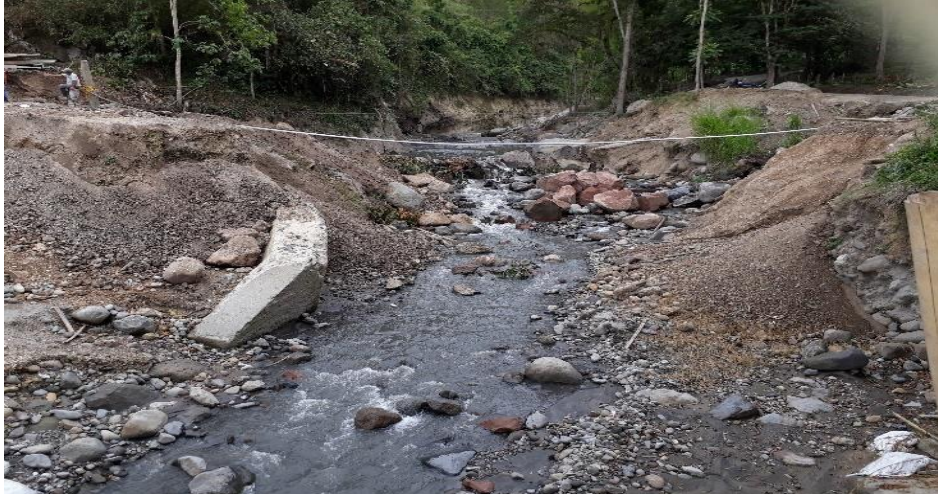
Figura 51. Detalle del sitio de los hechos PR 02+050 Quebrada San Andrés.
