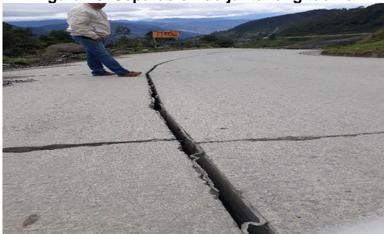
Figura 13. Separación de junta longitudinal
