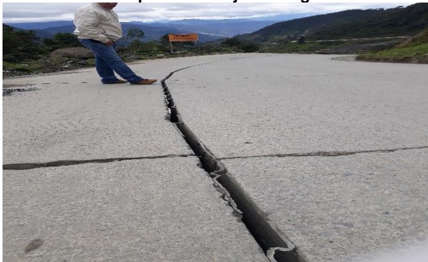
Figura 29. Detalle de la separación de junta longitudinal en el PR 70+400
