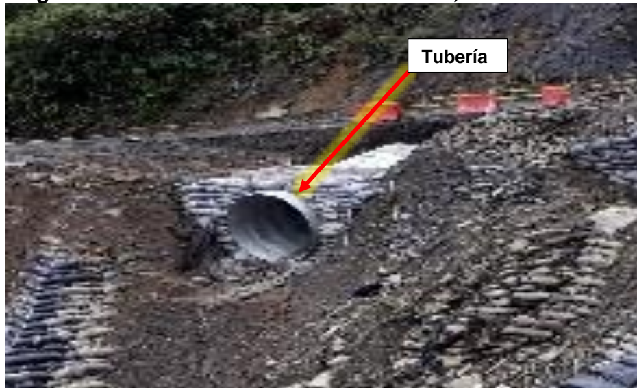
Figura 27. Detalle de tubería metálica de 3,6 m de diámetro.
