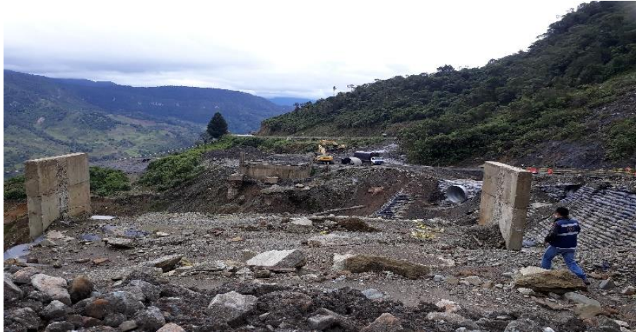
Figura 24. Detalle de los apoyos del Puente Córdoba que fue desmontado en el PR 70+600
