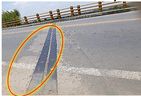
Figura 83. Descascaramiento del concreto en las juntas del Puente Miranda
