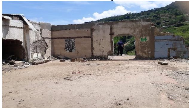
Figura 85. Detalle de vivienda afectada por la avalancha del Río La Paila.
