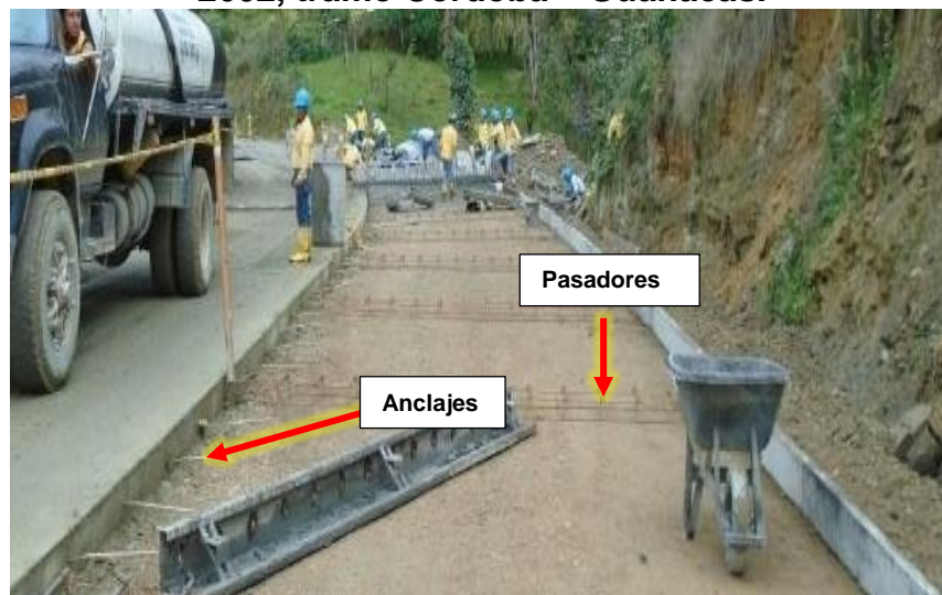
Figura 44. Detalle de pasadores y anclajes en el pavimento rígido en la ruta 2602, tramo Córdoba – Guanacas.
