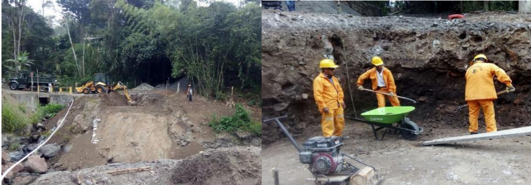
Figura 57 Apoyo de la margen izquierda, trabajos de excavación y nivelación de cota inferior para primera losa.
