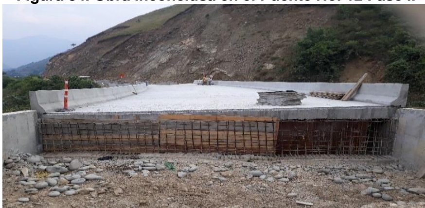
Figura 34. Obra inconclusa en el Puente No. 12 Fase II
