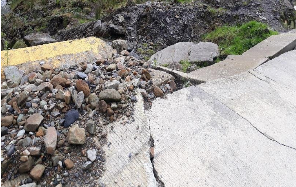
Figura 32. Detalle de falla en losa de pavimento y cuneta en el PR 70+500
