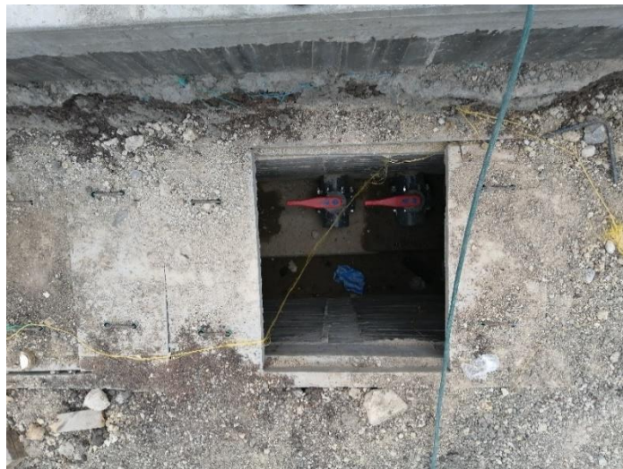
Figura 108 Válvulas caja de lavado
