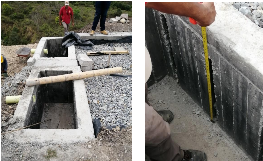
Figura 117 Revisión medida cajas de entrada
