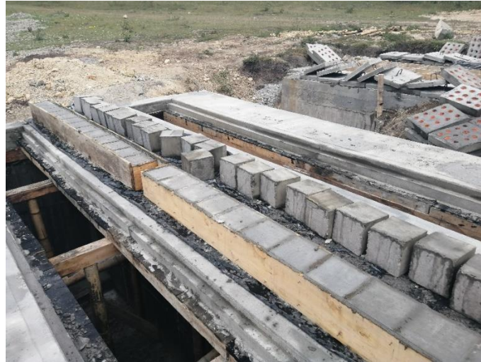
Figura 104 Pedestales filtro anaerobio
