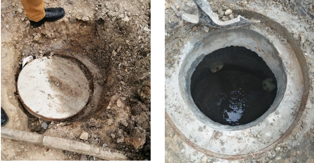
Figura 57 Cámara de inspección 10 sin cañuela
