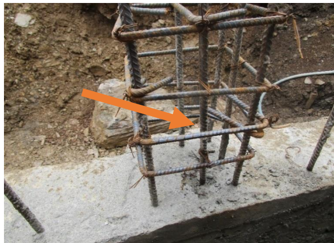
Figura 40 Acero longitudinal fuera de su eje
