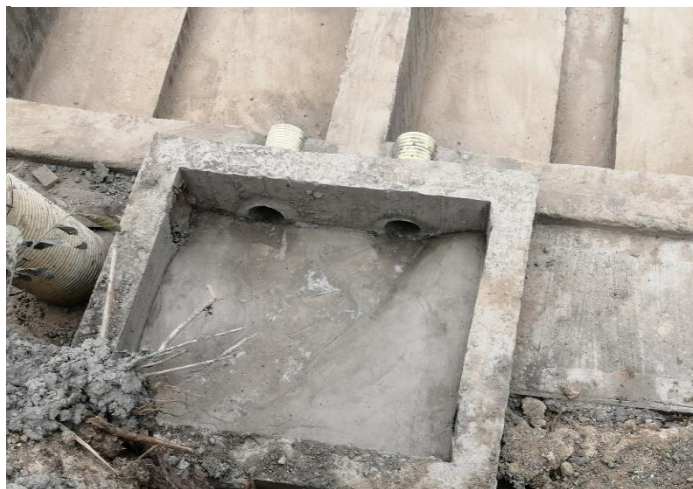
Figura 127 Cajas de entrada lechos de secado
