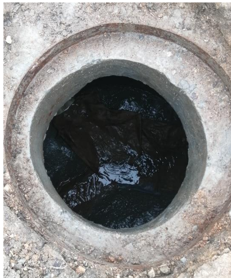
Figura 58 Cámara de inspección 10 con cañuela mejorada
