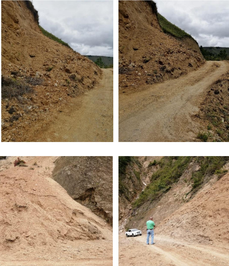
Figura 22 Derrumbes presentados en la vía de acceso al Resguardo de Chinas
