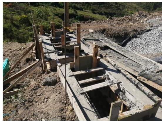
Figura 114 Cajas de entrada biofiltro
