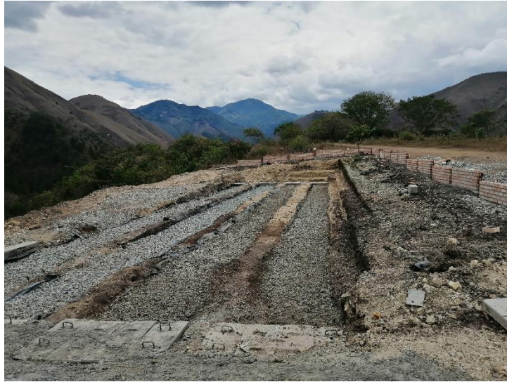
Figura 125 Biofiltro, al lado derecho la terraza
