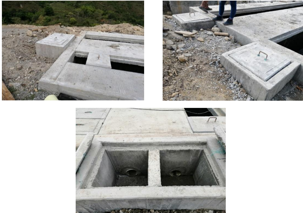
Figura 110 Cajas de salida y entra tanque séptico y FAF
