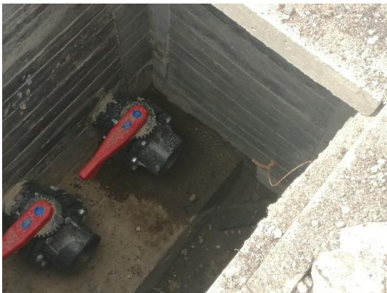
Figura 112 Humedad en caja de lavado
