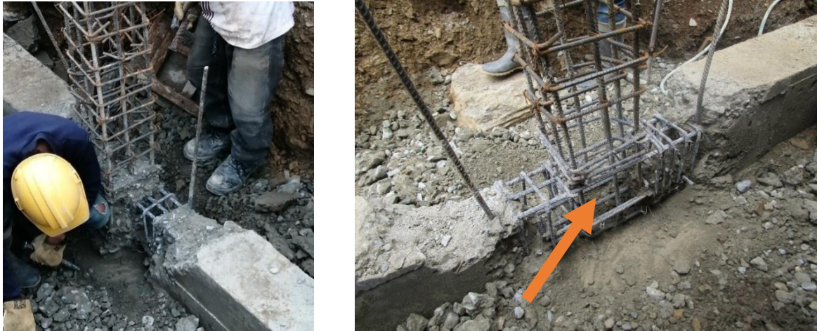
Figura 41 Acero longitudinal fuera de su eje
