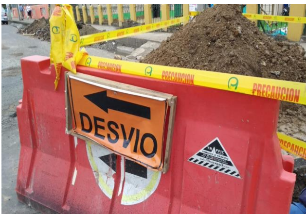
Figura 55. Intersección de la Calle 25 Norte con la carrera 5. Desvío de cierre total.
