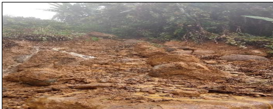
Figura 10. Afectación de alcantarillado por derrumbe
