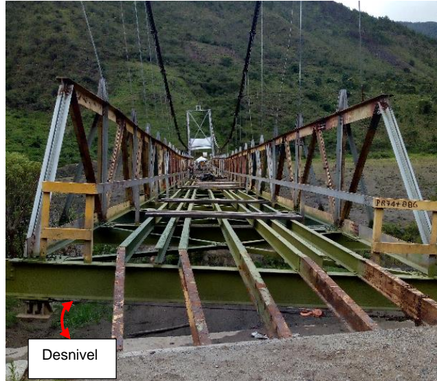
Figura 8.22. Desnivel visto de frente del puente.
