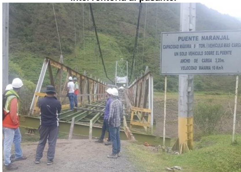
Figura 8.24. Explicación de algunas fallas del puente por el Director de interventoría al pasante.
