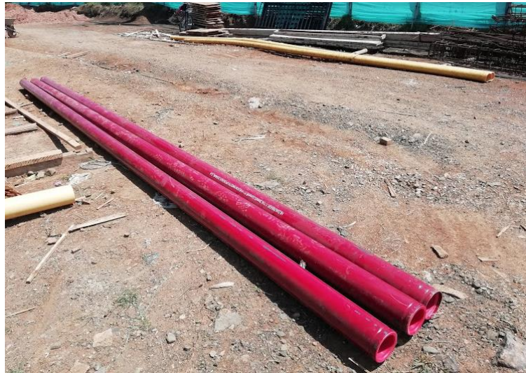
Ilustración 46 Tubería red contra incendios
