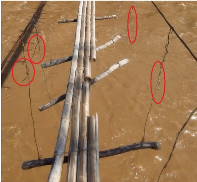
Ilustración 8. Alambres que se enredan en las cargas que se transportan por el puente. Fuente: Propia.
