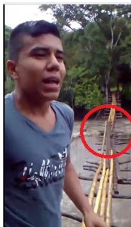
Ilustración 18. Usuario afectado por el riesgo que representa cruzar el puente cuando el río está en aumento. Fuente: Propia.
