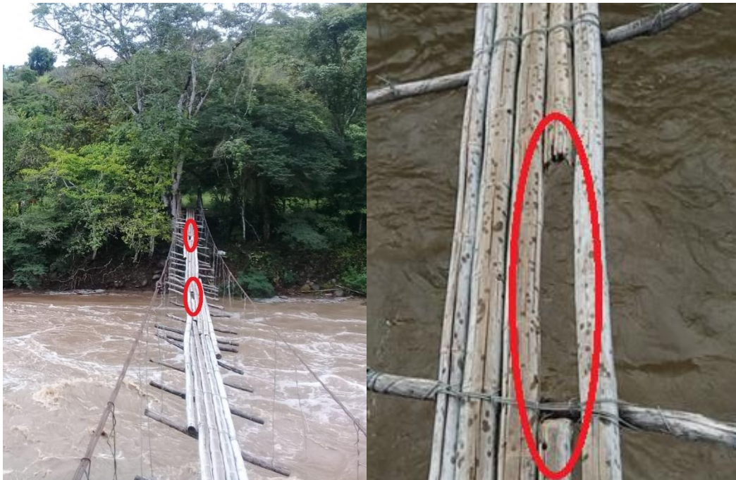
Ilustración 7. Tablero deteriorado hecho en guadua. Fuente: Propia.
