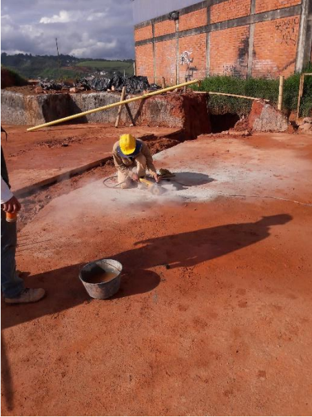
Figura 43. Cortes en solado Torre C
