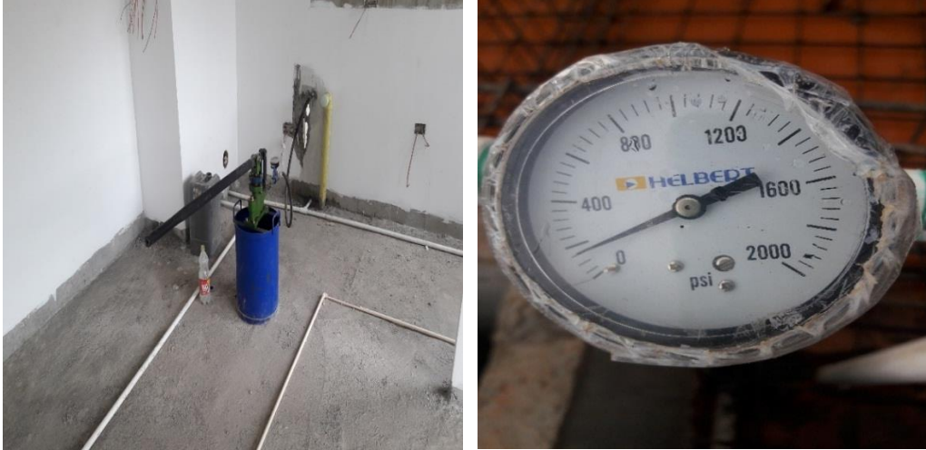
Figura 6. Bomba Hidráulica Localización: Torre A Apartamento 401
