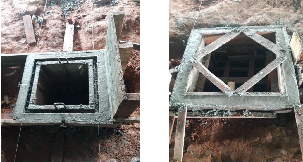
Figura 58. Cajas de inspección fundidas en concreto simple
