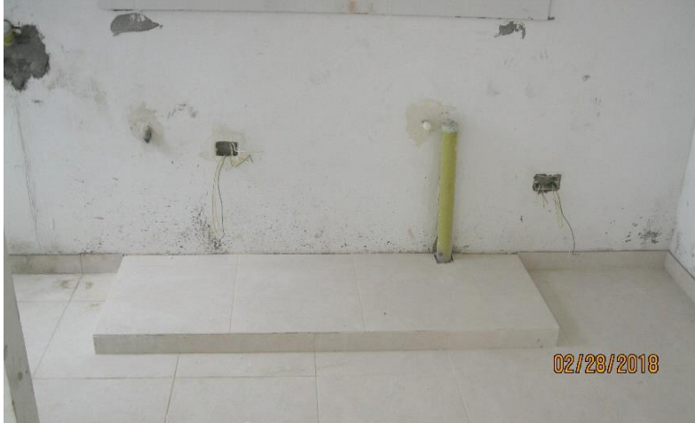
Figura 10. Detalles enchape piso apartamento
