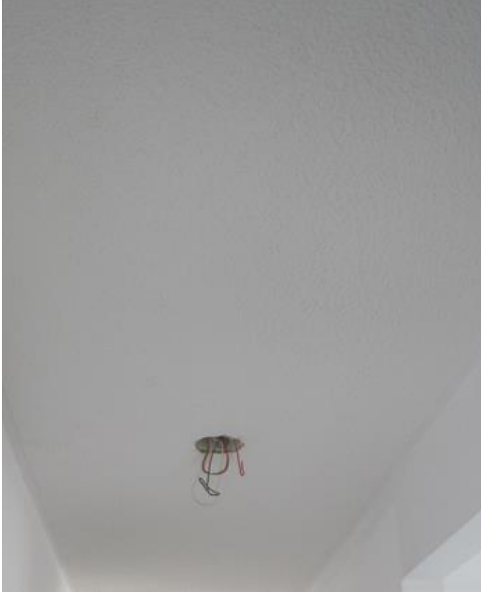
Figura 23. Textura en techos interiores Apartamento 201
