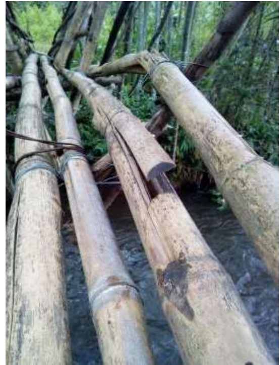
Foto 6. Deterioro normal del puente
