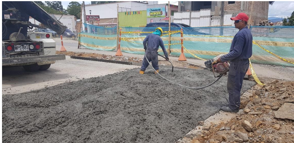
Figura N°28: Vibrador de aguja - Proceso de vibrado en fundición de reductor de velocidad.
