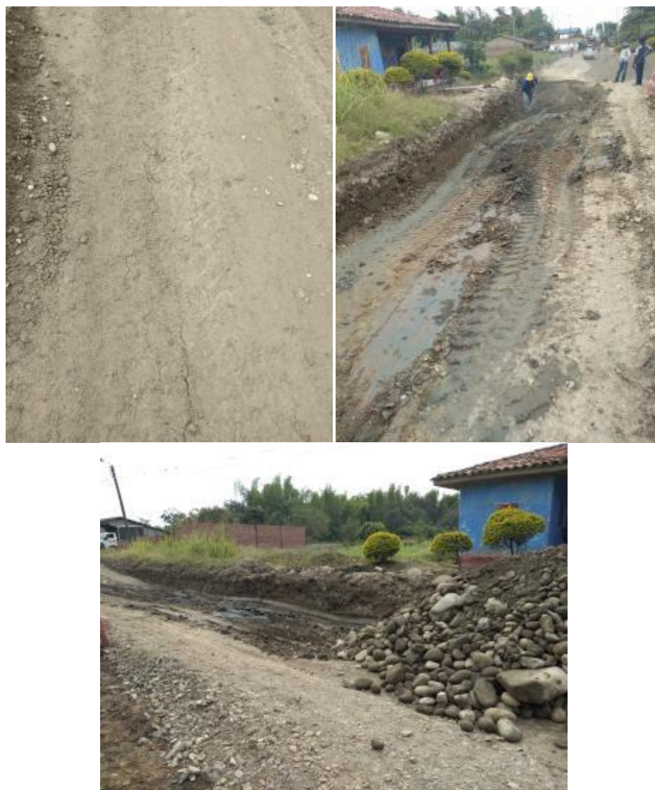
Fig. 20. Identificación, retiro y reemplazo de fallo en el terreno.
