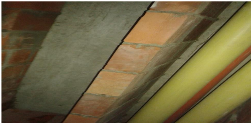
Figura 68. Buitrón para tuberías
