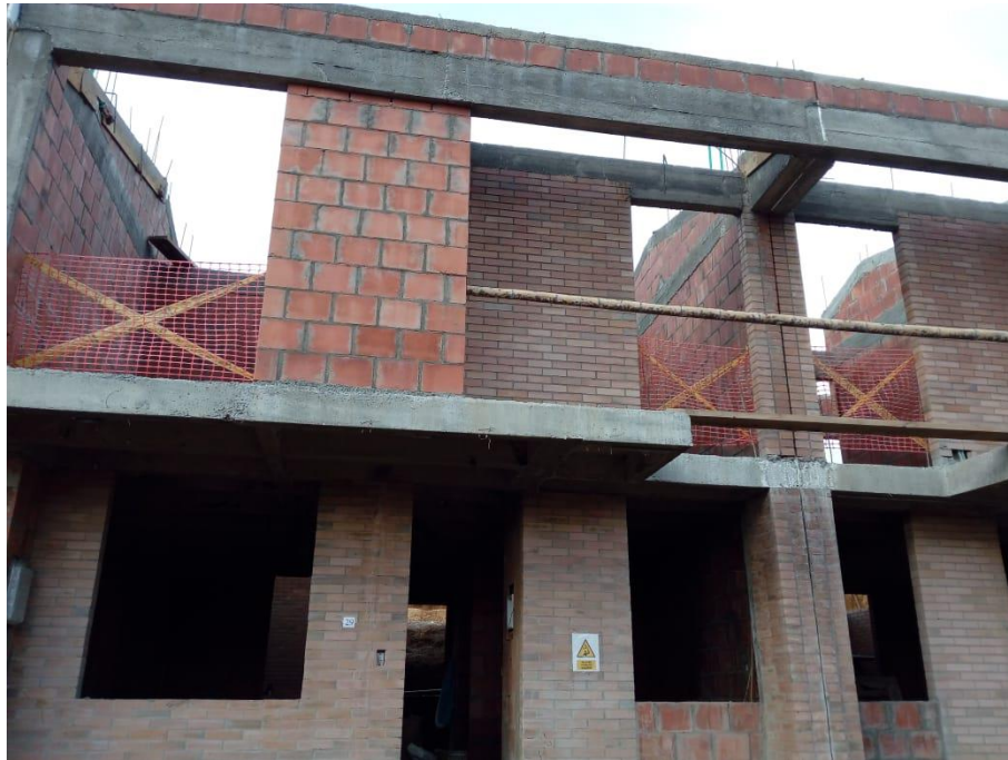
Figura 104. Señalización en alturas
