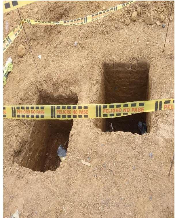
Figura 40. Cajas de inspección
