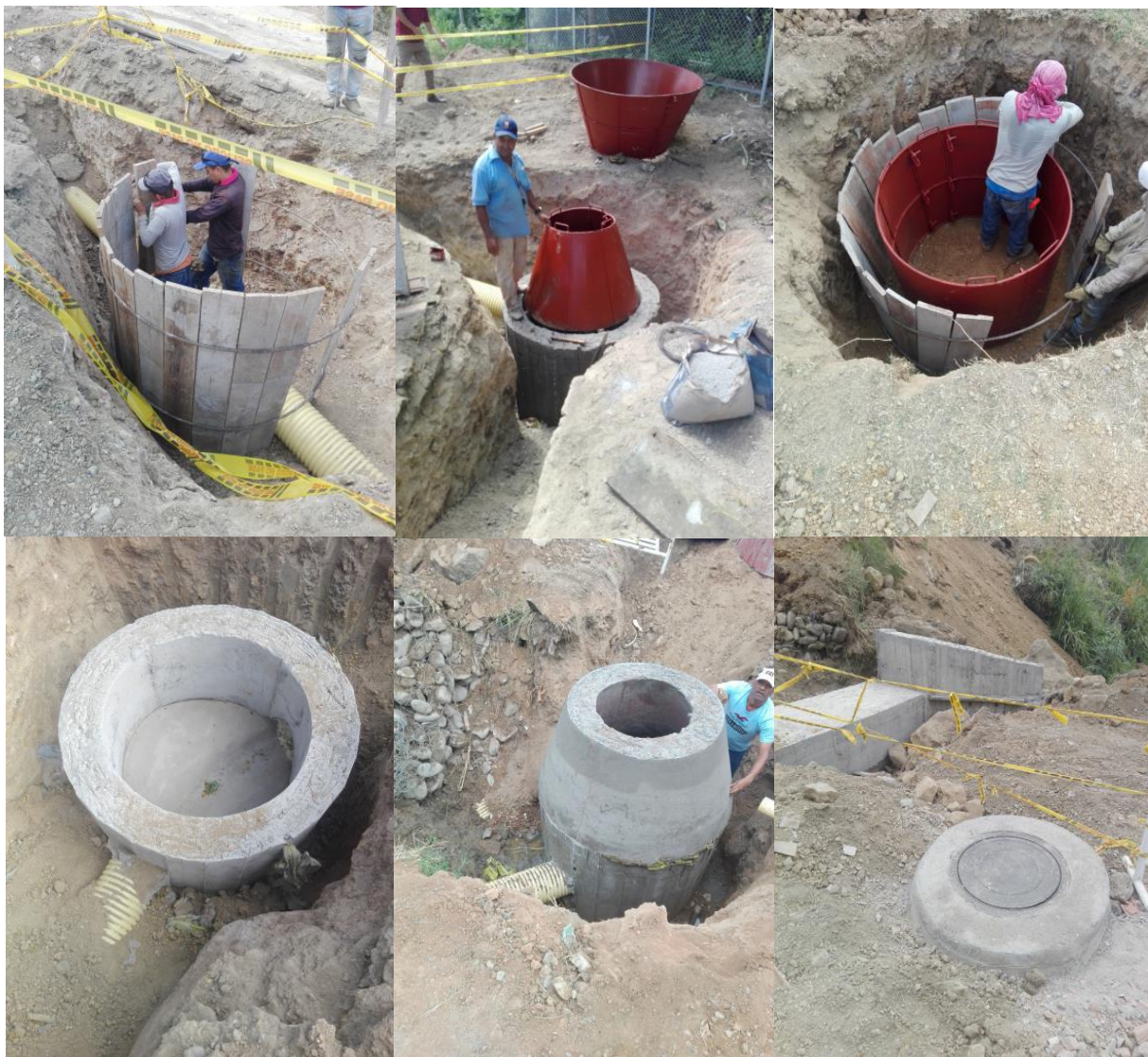
Figura 11. Cámaras de inspección.
