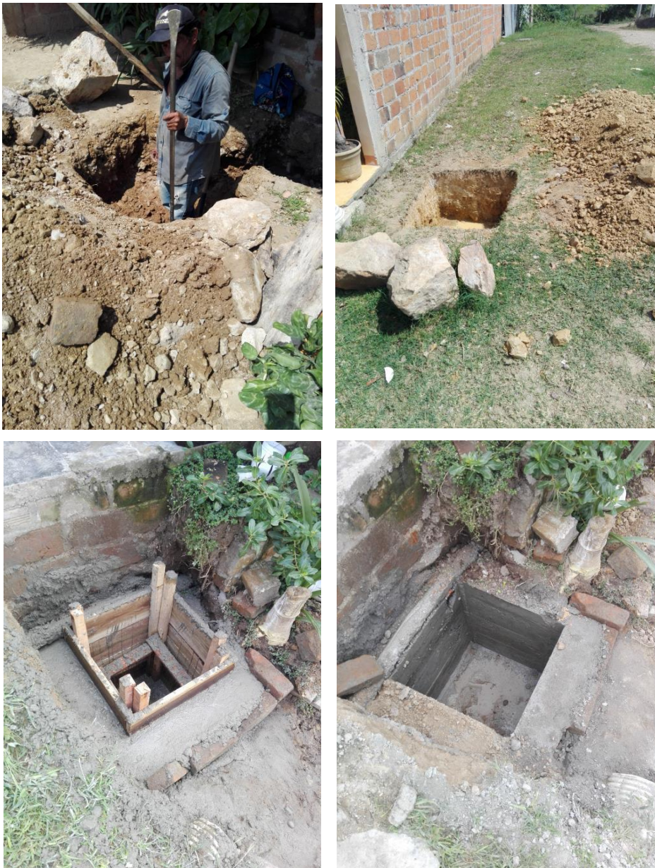
Figura 14. Cajillas de inspección domiciliarias.
