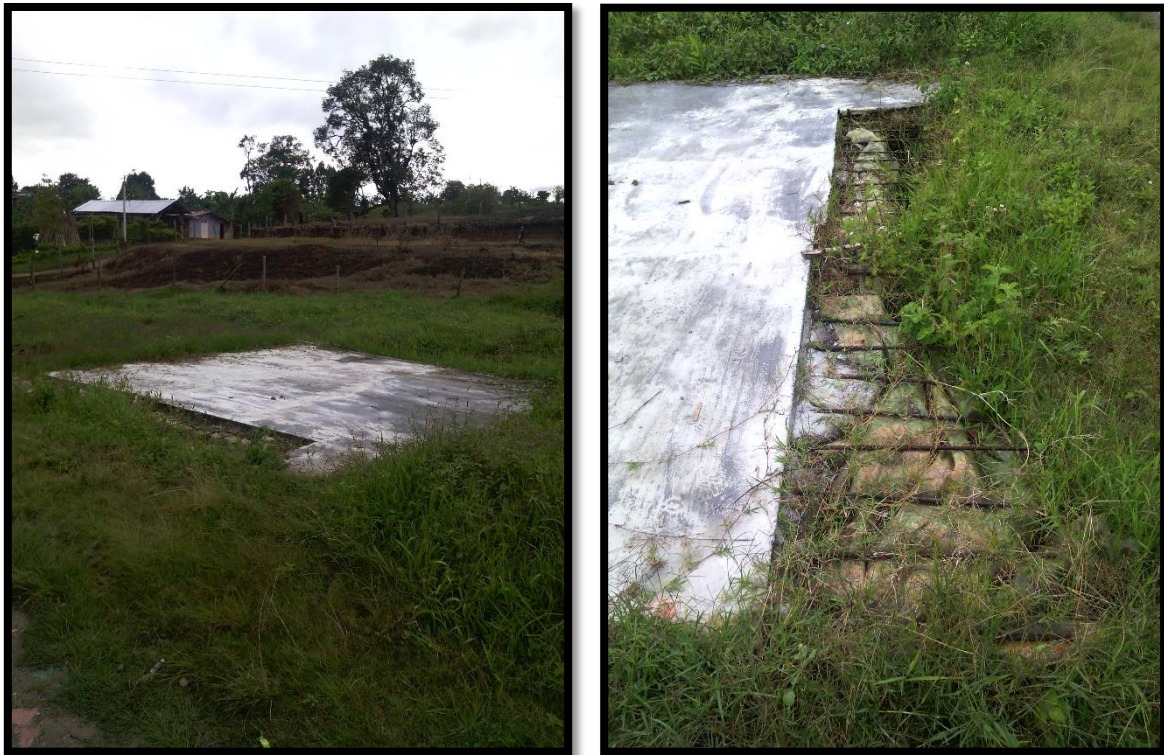
Figura 27. Tanque séptico nuevo - placa faltante (tapa).
