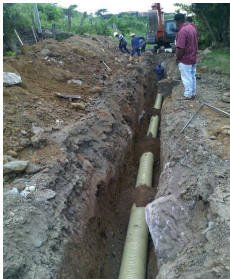
Figura 15. Fallas en el proceso constructivo.
