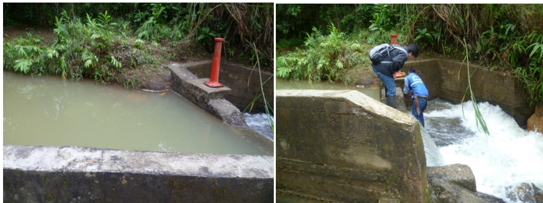
Figura 4. Fotografías sistema de captación
