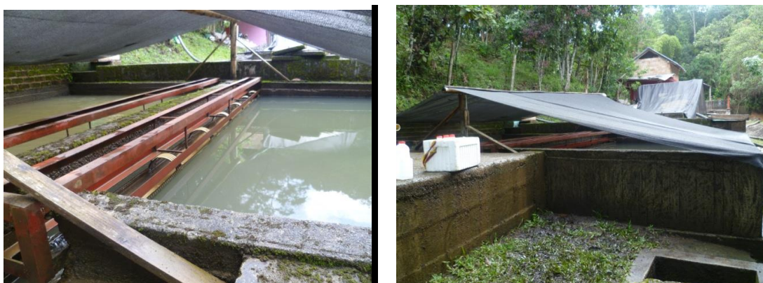
Figura 8. Fotografía estructura filtros gruesos ascendentes
