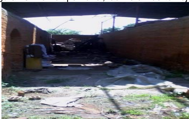
Figura 10. Horno tipo Túnel, ladrillera Puerto Tejada
