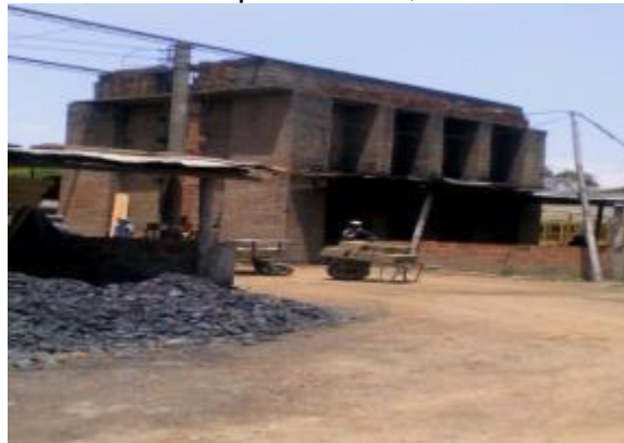
Figura 11. Horno tipo PAMPA, ladrillera Ladritec
