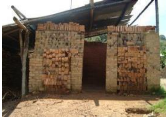
Figura 5. Horno PAMPA 1, Ladrillera Los Tejares
