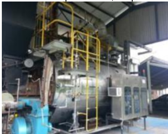
Figura 2. Caldera pirotubular, Empresa Ripals
