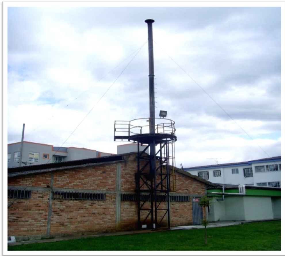
Figura 3. Área de Calderas del Hospital Susana López de Valencia E.S.E
