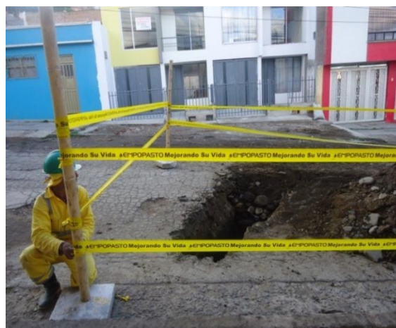
Figura 37. Escombros y material sobrante señalizados.
