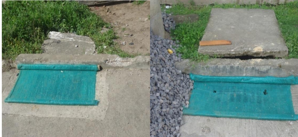
Figura 44. Protección de sumideros.
