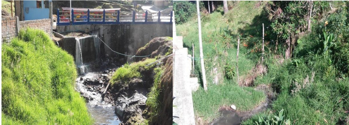
Figura 1. Vertimientos de agua residual sobre la quebrada (fotografía Carlos Eduardo Oñate)
