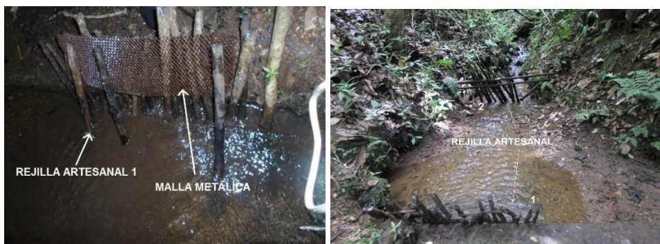
a. Entrada a bocatoma
