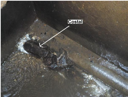
Figura 9. Tubería averiada, bocatoma
