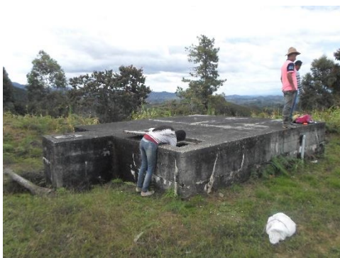
Figura 20. Tanque de almacenamiento de agua
