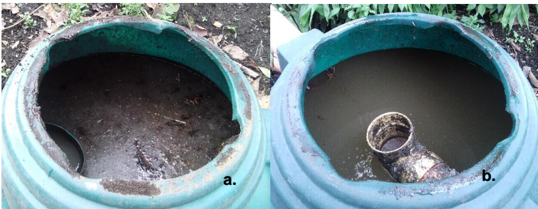
Figura 8. a. Tanque de sedimentación, b. Filtro anaerobio de flujo ascendente (FAFA).
