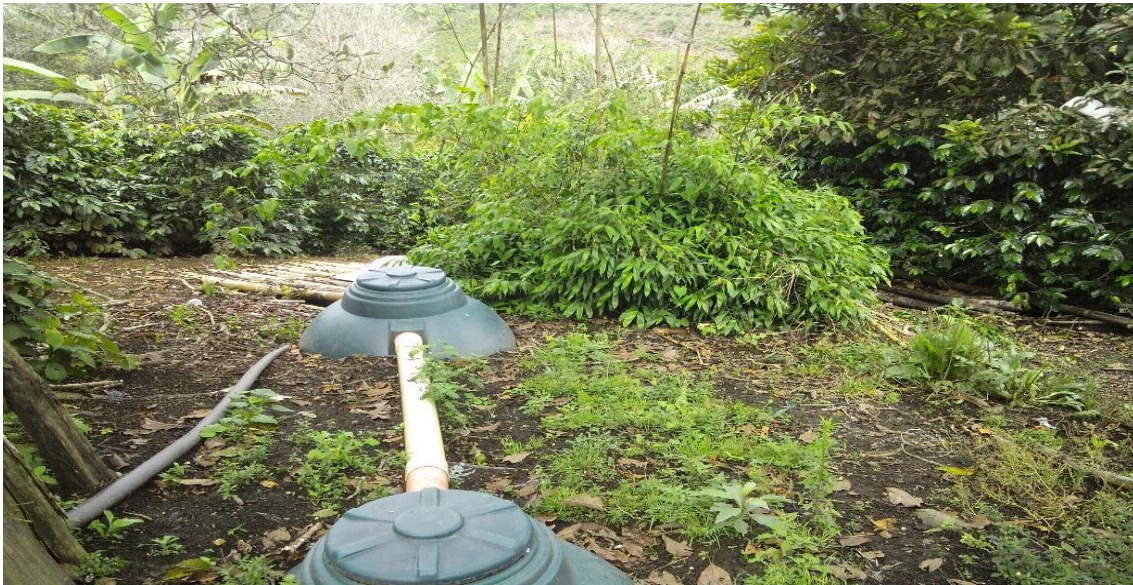
Figura 7. Sistema de tanques y laguna de infiltración.
