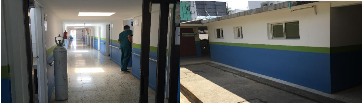
PISOS Y PINTURA DE LOS PASILLOS DEL AREA DE HOSPITALIZACION Y PEDIATRIA
