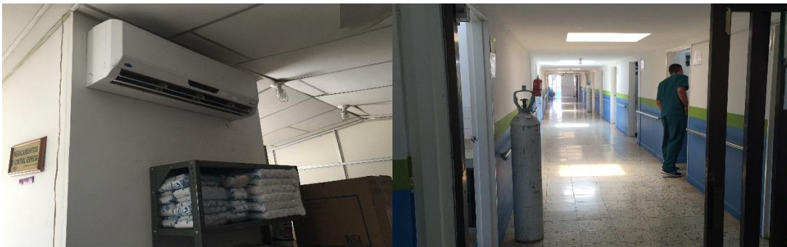
AREA DE FARMACIA QUE ESTA AL LADO DE URGENCIAS Y NO SE VE TRABAJOS RECIENTE EN ESTE LUGAR Y DE LA MISMA MANERA SUCEDE EN EL AREA DE HOSPITALIZACION
