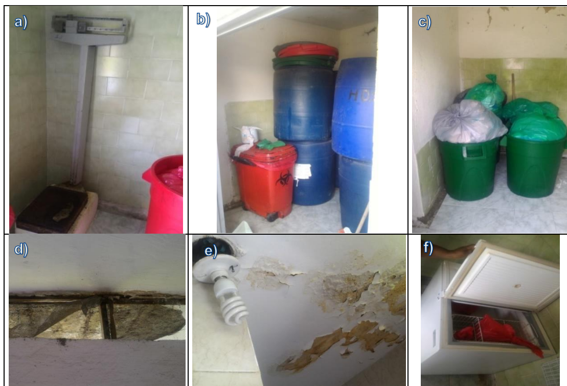
Figura 9. Almacenamiento Central Hospital Nivel 1 Puerto Tejada. a) Báscula. – b) Recipientes para Residuos. – c) Residuos Ordinarios. – d) Malla deteriorada. – e) Residuos Anatomopatológicos.
