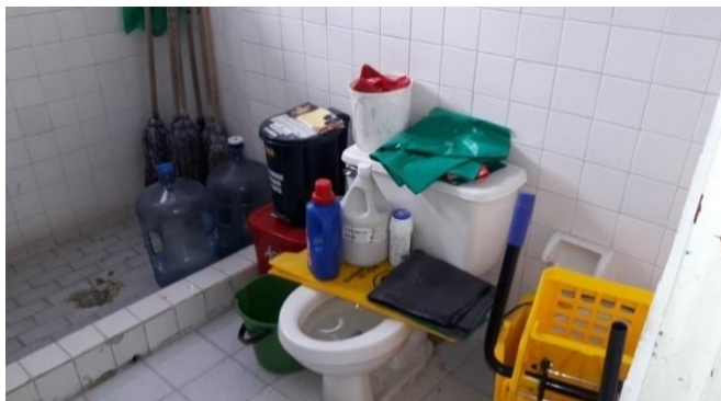
Figura 11. Baño dañado cumpliendo las funciones de cuarto de aseo, Punto de Atención Mercaderes
