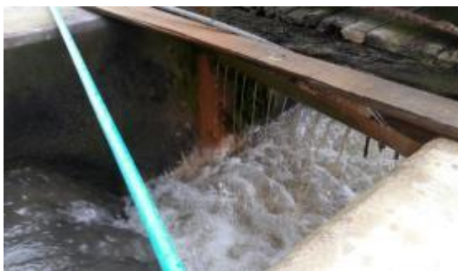
Figura 12. Vertedero rectangular en la PTAP
