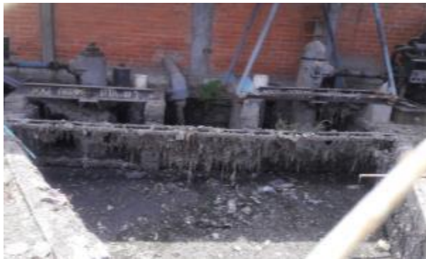
Figura 15. Estación de bombeo de aguas residuales
