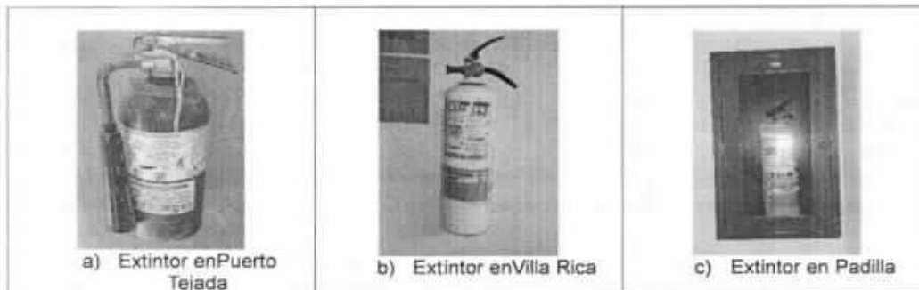
Figura 10. Carencia de extintores en los Puntos de Atención de la ESE
