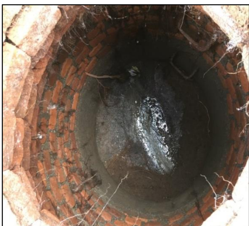
Figura 12: Cámara de inspección en regular estado
