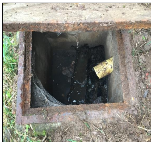
Figura 13: Caja de inspección en mal estado
