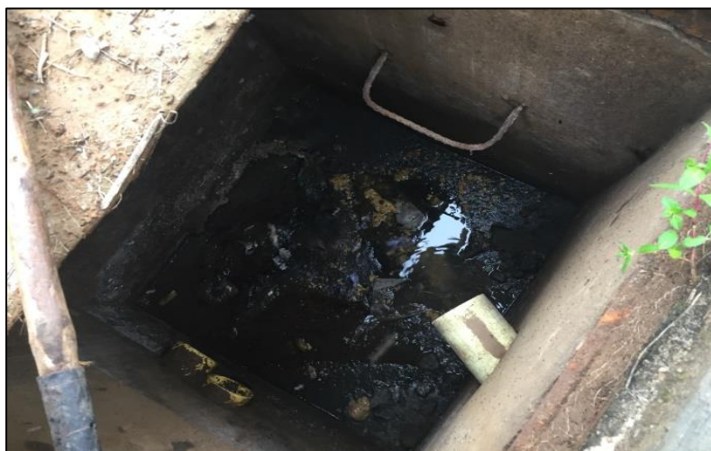
Figura 7: Caja de inspección sedimentada
