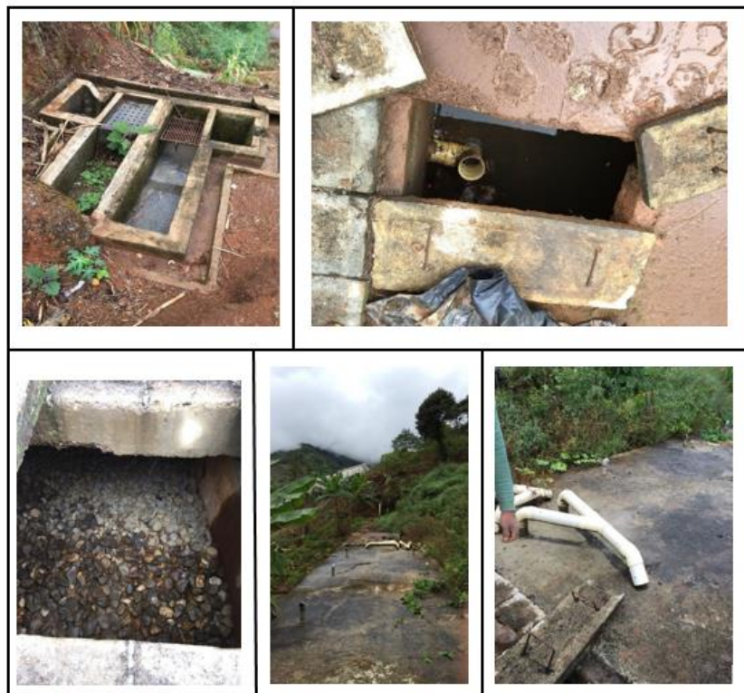
Figura 50 PTAR Corregimiento La Mesa
