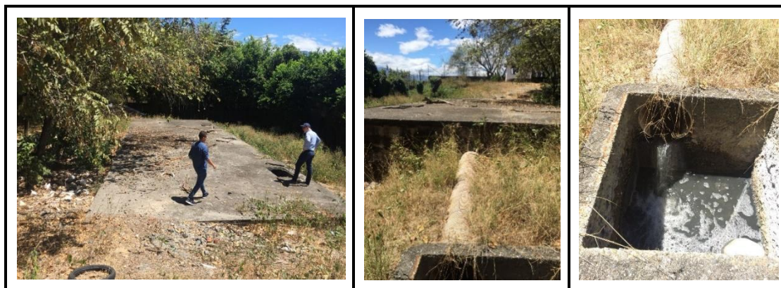
Figura 44 PTAR El Estrecho
