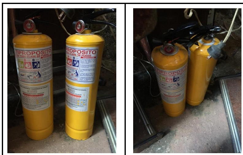
Figura 56 Extintores sin señalización
