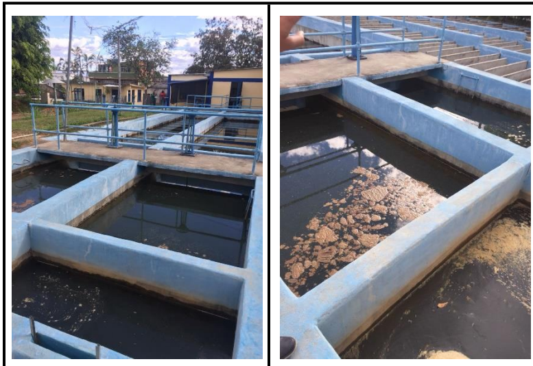
Figura 38 Sedimentadores y Reservorio
