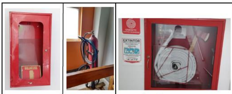
Figura 23 Falta de extintores y su señalización
