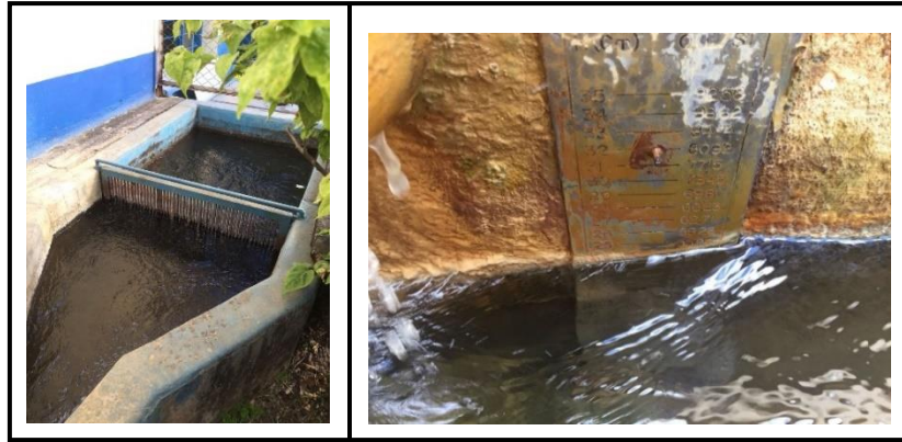
Figura 35 Caudal captado, rejilla
