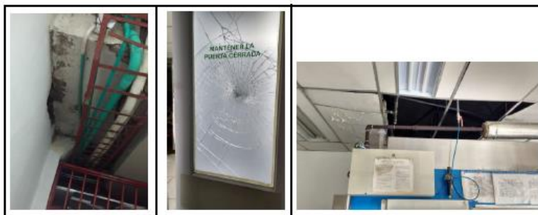
Figura 20 Problemas de Infraestructura
