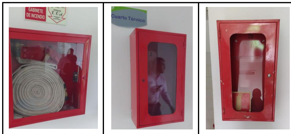
Figura 33 Carencia de Extintores
