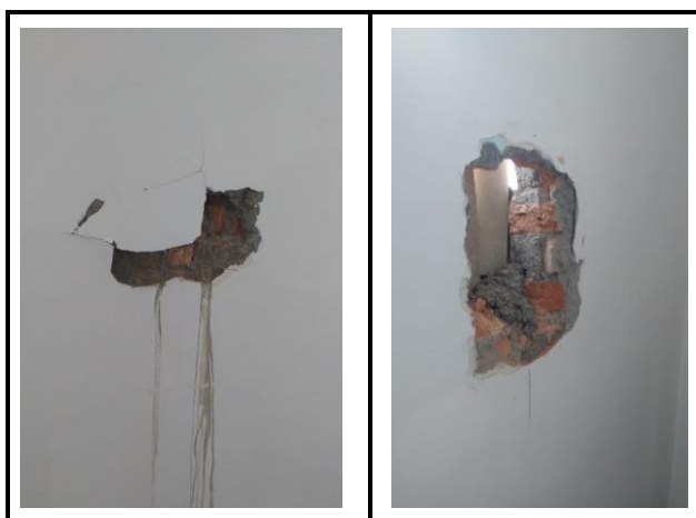
Figura 34 Daños en la Infraestructura
