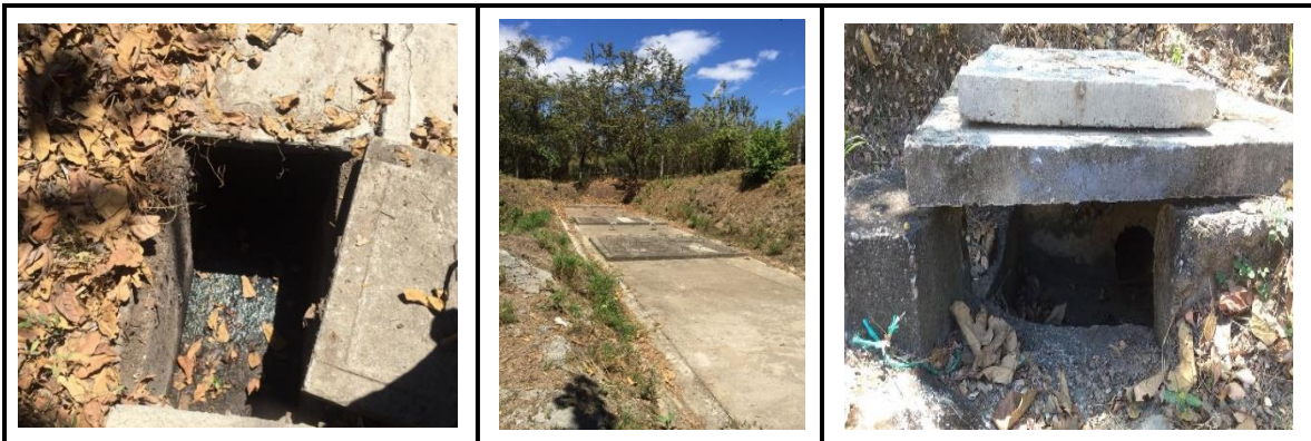
Figura 46 PTAR El Estrecho Barrio La Paz
