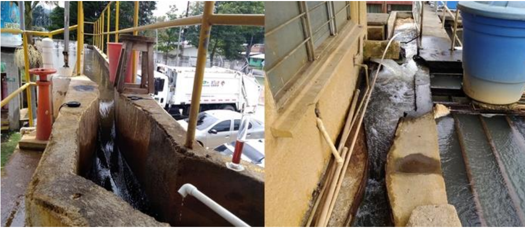
a. Primer punto: Entrada del agua cruda a la planta. b. Segundo punto: Agua con coagulante.
