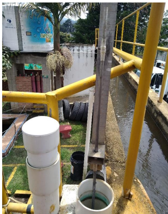
Figura 10. Medidor de caudal de entrada.
