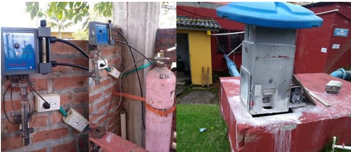
d. Bomba dosificadora de cloro.
