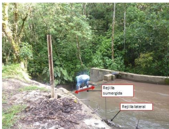
Figura 5. Rejilla sumergida y lateral, sistema de captación bocatoma.
