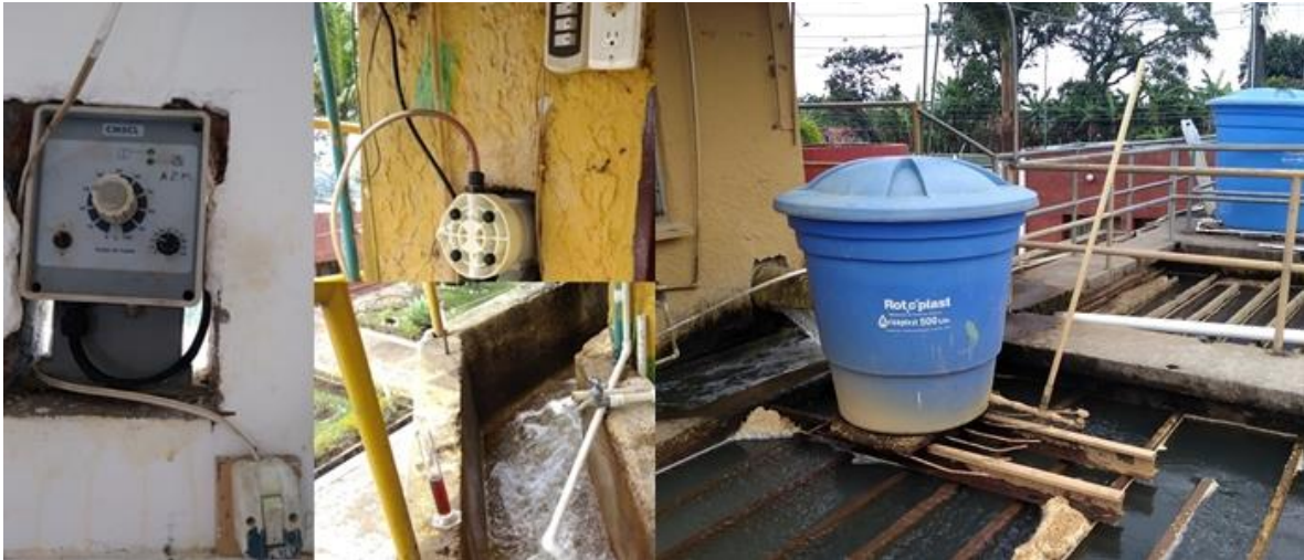
a. Bomba dosificadora de sulfato de aluminio.
