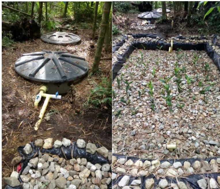
Figura 4. Sistema de tratamiento de aguas residuales de la Corporación Maestra Vida (fuente propia)
