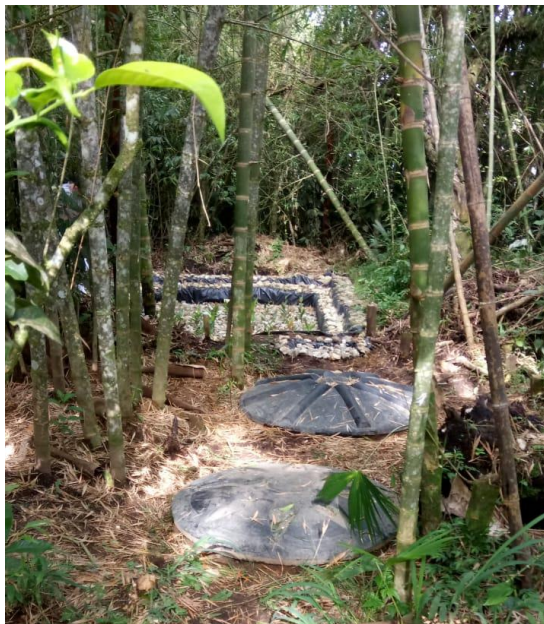
Figura 7. Ubicación del sistema de tratamiento de aguas residuales de la Corporación Maestra Vida (fuente propia).
