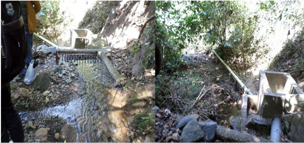
Foto. 3 Sistema de captación quebrada “El Helechal”.
