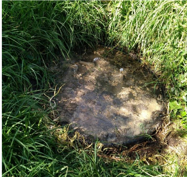
Figura 12: Tanque sedimentador colmatado.
