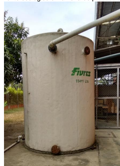
Fotografía No: 4 Lugar: Zona exterior Observación: tanque de almacenamiento de aguas lluvias, la conexión superior descarga el agua de los colectores de aguas lluvias del tejado.
