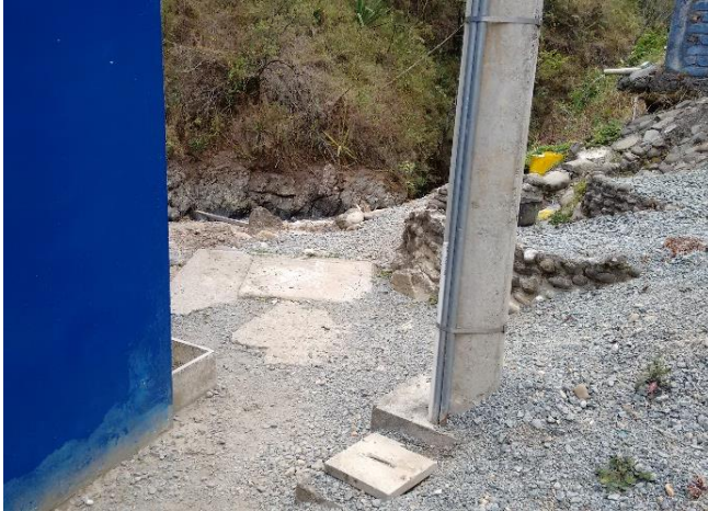
Fotografía No: 1 Lugar: PCH Patico Observación: Tanque séptico bajo una losa de cemento.
