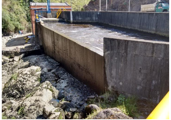
Fotografía No: 2 Lugar: PCH Patico Observación: Sedimentador/canal de conducción desde el dique, hacia la turbina en casa de máquinas.
