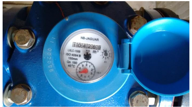
Fotografía No: 2 Lugar: PTAP Parque Sur Observación: Medidor volumétrico de caudal en la entrada de la PTAP.
