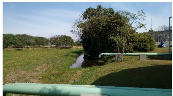
Fotografía No: 4 Lugar: PTAP FAREVA S.A.S Observación: Tuberías de descarga de excedentes de agua provenientes de los tanques de almacenamiento hacia el humedal Genfar.
