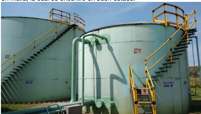
Fotografía No: 3 Lugar: PTAP FAREVA S.A.S Observación: Tanques de almacenamiento de 900 m 3 para agua cruda (izquierda) y de 300m 3 para agua potable (derecha)
