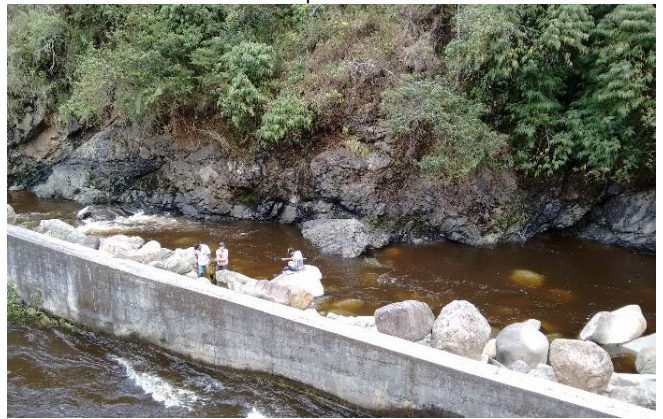
Fotografía No: 4 Lugar: PCH Patico Observación: Tramo del río después de la descarga de las compuertas, no se observa acumulación de sedimentos en el cauce.
