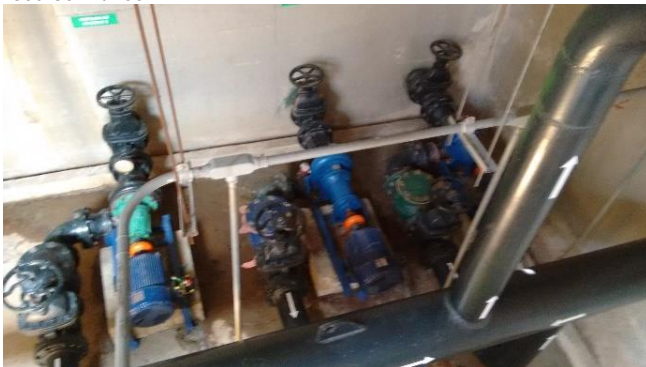
Fotografía No: 3 Lugar: PTAP Observación: Estación de Bombeo al interior de la PTAP.
