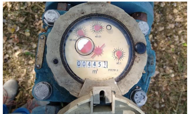
Fotografía No: 2 Lugar: PTAP FAREVA S.A.S Observación: Medidor volumétrico de caudal a la entrada de la PTAP en el cual se registra el volumen acumulado que se extrae del pozo.
