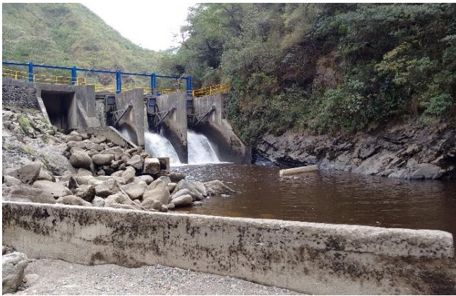
Fotografía No: 3 Lugar: PCH Patico Observación: Descarga de las compuertas, no se evidenció acumulación excesiva de arena o sedimentos.
