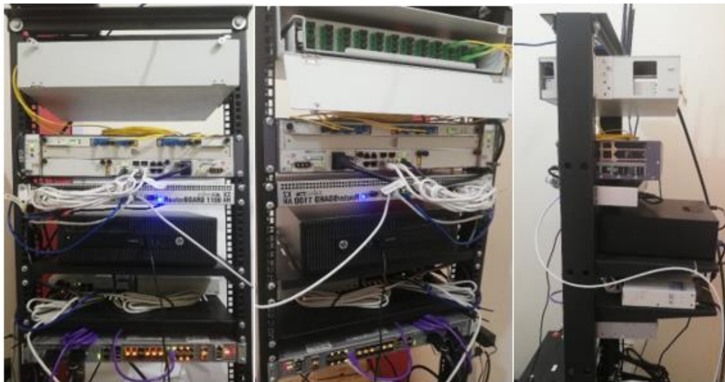
Figura 3.6 Equipos oficina central Telcofiber
