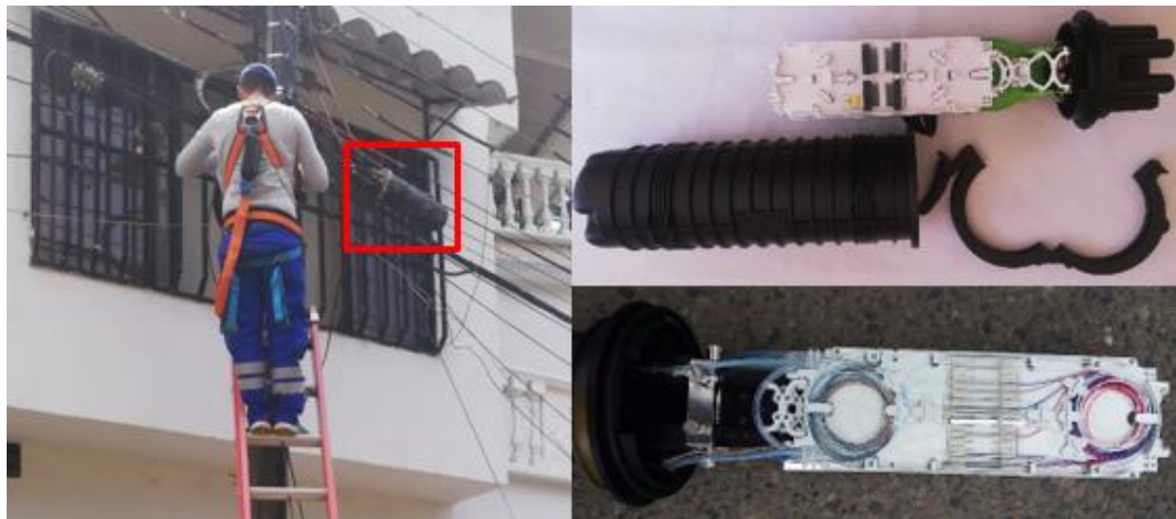
Figura 3.17 FDT- Caja de empalme o Mufla
