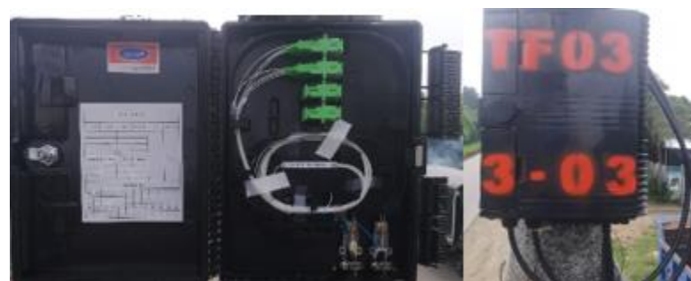
Figura 3.21 Caja de distribución óptica- FAT
