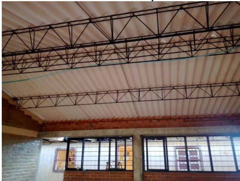
FIGURA 35. Cubierta en fibrocemento pintada con hidrocarburo
