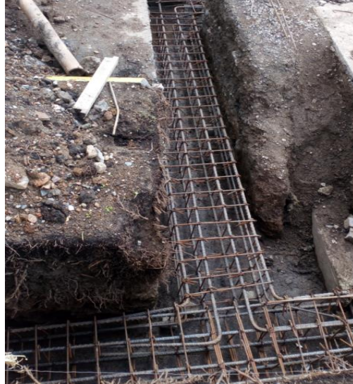
Figura N° 23 (Rojas C, 2018) Zanja con aceros puesto y listo para fundición de vigas. Foto tomada en sitio
