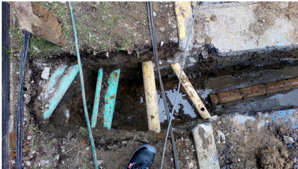
Figura N° 22 (Rojas C, 2018) Redes existentes encontradas durante la excavación. Foto tomada en sitio
