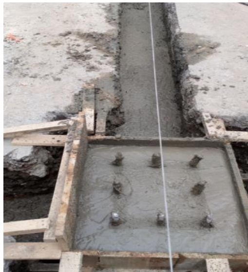
Figura N° 24 (Rojas C, 2018) Fundición de vigas y zapata con pedestal por método de muros colocados. Foto tomada en sitio
