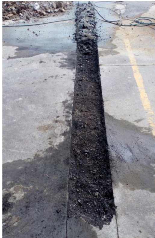
Figura N° 20 (Rojas C, 2018) Demolición y excavación de vigas de cimentación. Foto tomada en sitio
