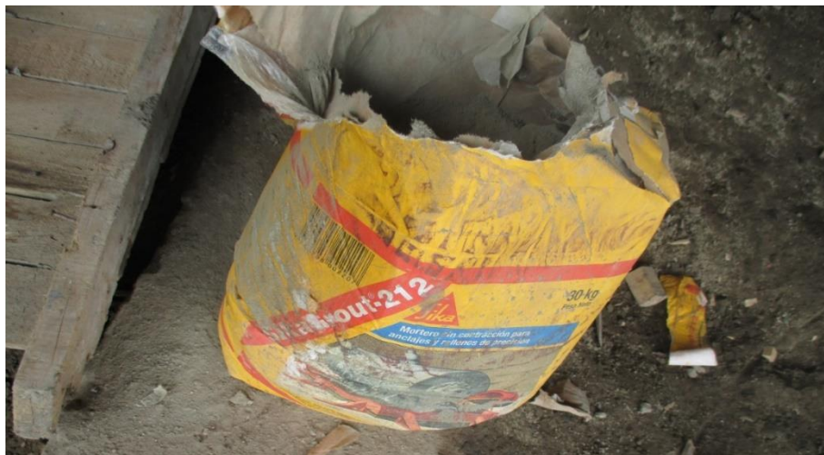
Figura N° 28. (Rojas C, 2019) Saco de sika grout usado para fundir la base de la columna metálica. Foto tomada en sitio
