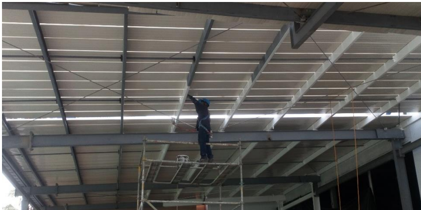
Figura N° 33. (Rojas C, 2019) Instalación de primera capa de cubierta. Foto tomada en sitio
