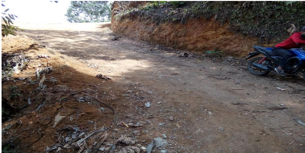
Figura 27. Vía sin cunetas.
