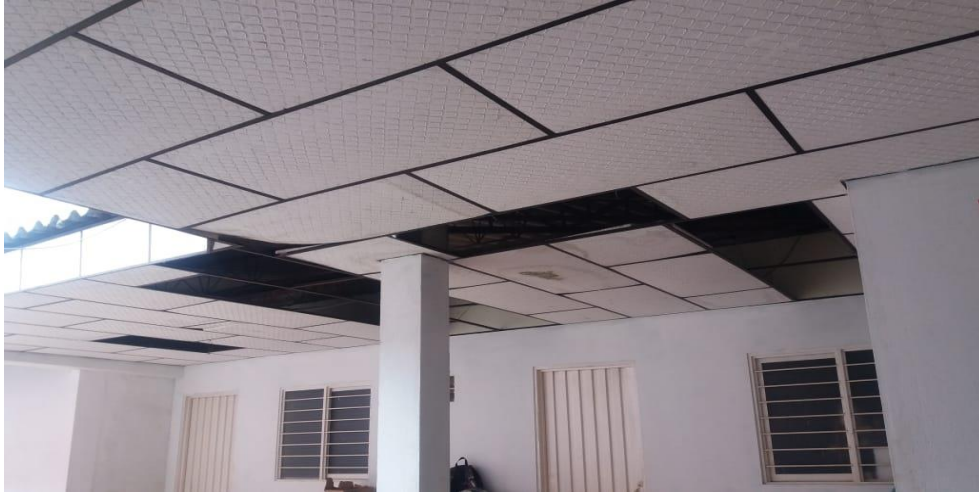
Figura 19. Cielo falso de la vivienda a mejorar.
