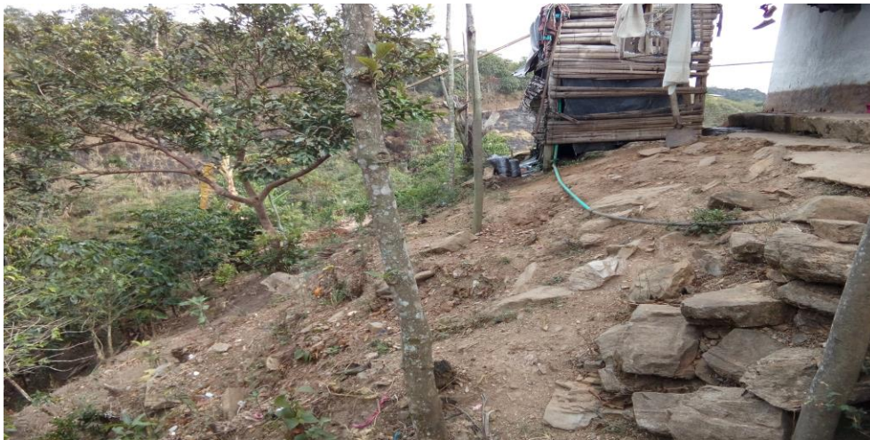
Figura 26. Zona de desestabilización.
