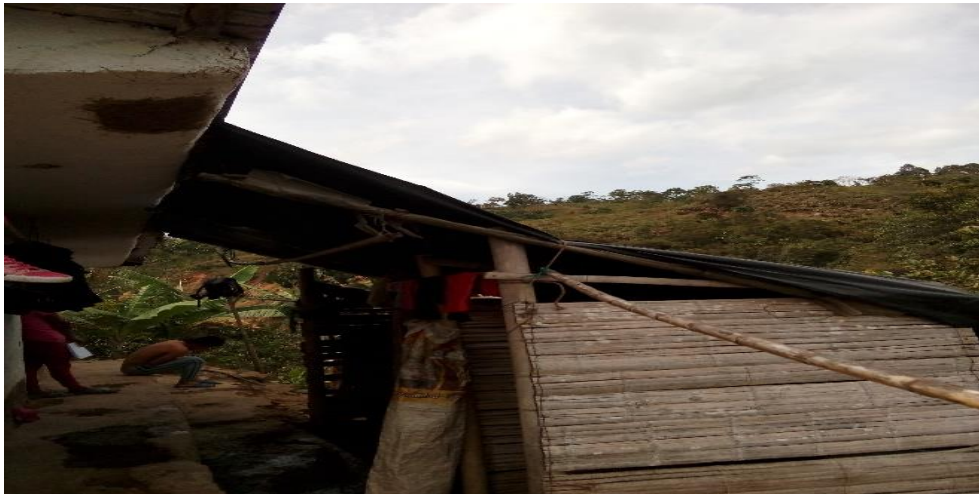
Figura 24. Vivienda sin sistema de canalización de aguas lluvias.
