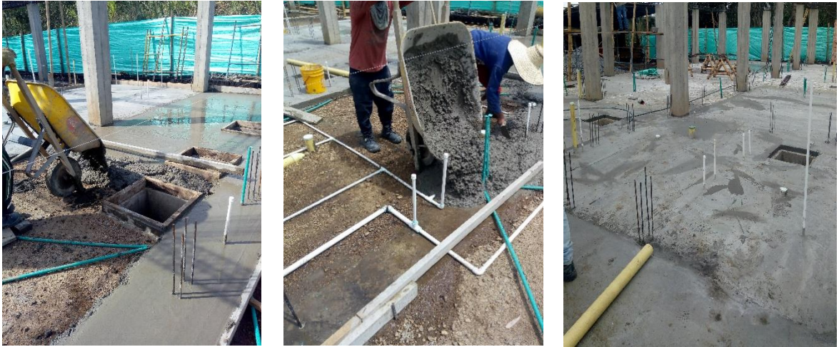
Imagen 84. Fundición del primario en zonas de cajas de inspección y resultado final.
