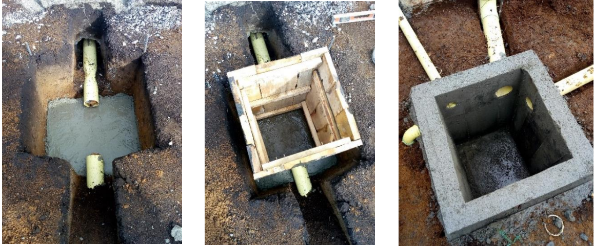
Imagen 81. Caja de inspección aguas grises.
