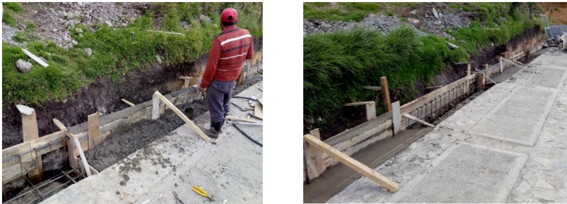
Imagen 39. Fundición cuneta y bordillo lado derecho, en el primer tramo de la placa.
