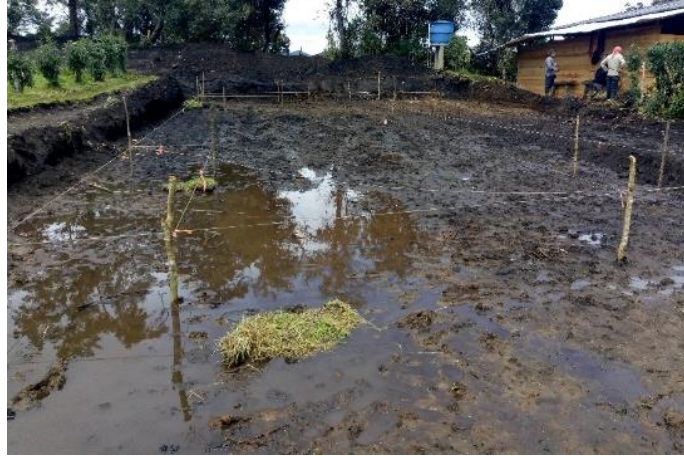
Imagen 53. Replanteo y estado del terreno luego de las fuertes lluvias.
