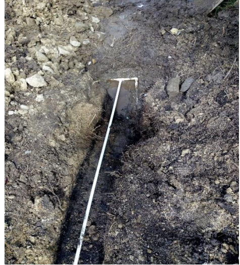
Imagen 21. Daño en la tubería del acueducto.
