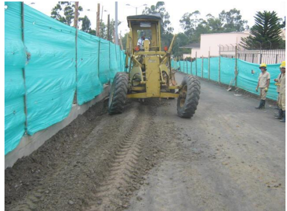
Foto #22 Escarificación fallo en el borde
