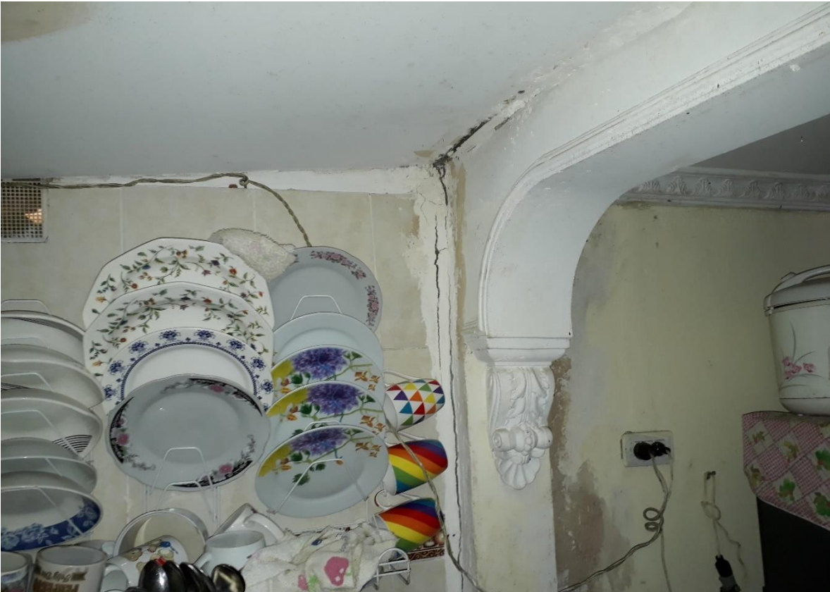
Ilustración 63. Daños en la vivienda
