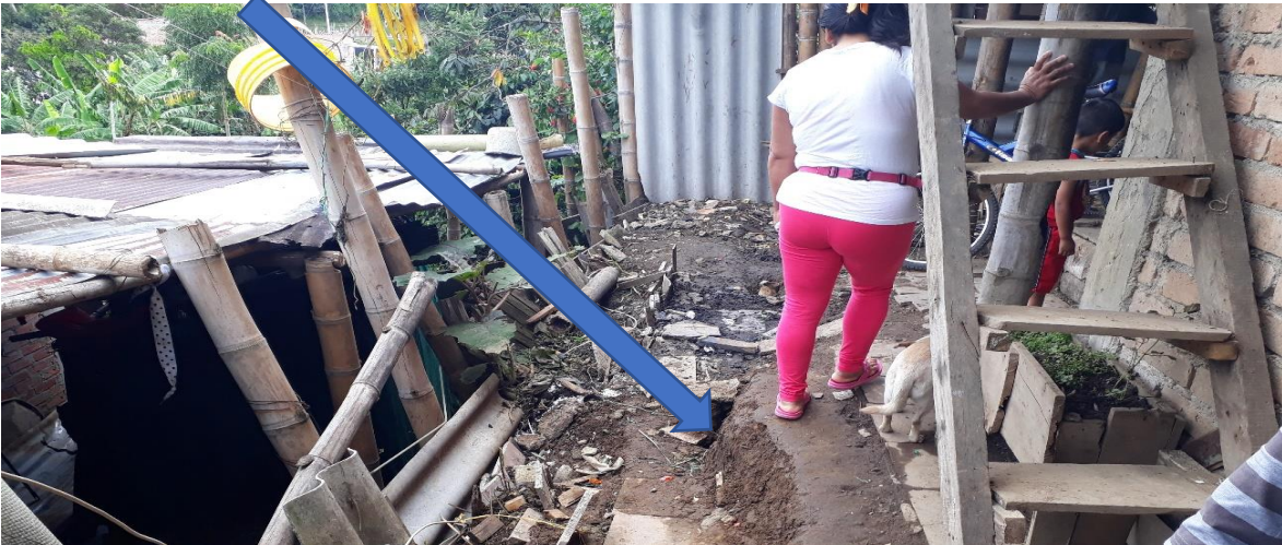
Ilustración 59. Fractura generada por el talud que está cediendo
