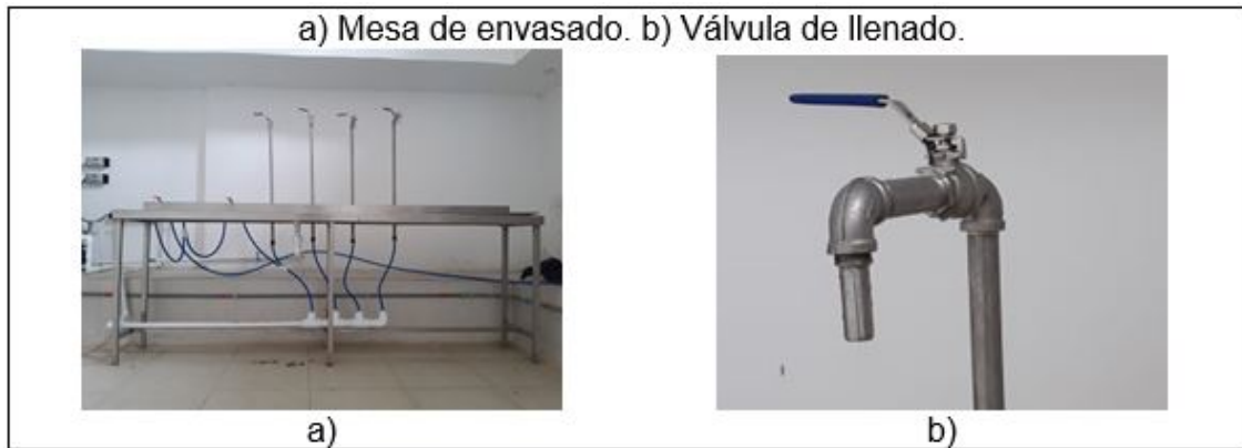
Figura 3.9: Equipos de unidad de envasado. Fuente: Acueducto y Alcantarillado de Popayán S.A. E.S.P.
