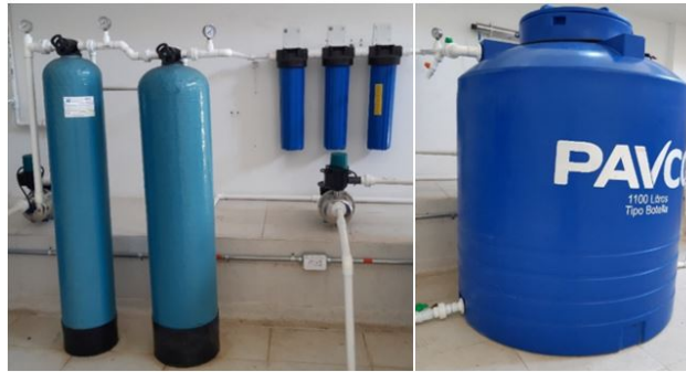
Figura 3.3: Filtración y Almacenamiento 2. Fuente: Acueducto y Alcantarillado de Popayán S.A. E.S.P.
