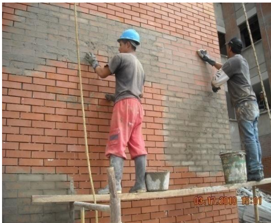
Fig. 25. Revoque en dilataciones de fachaleta.
