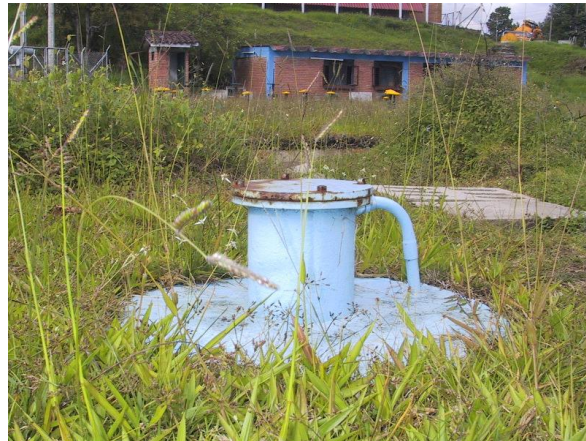
Figura 17: Sensor de nivel sobre los tanques de almacenamiento
