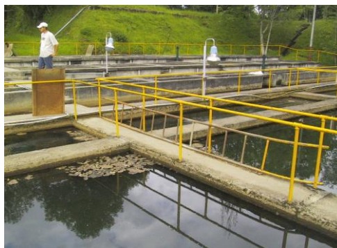
Figura 7: Foto de floculadores hidráulicos.
