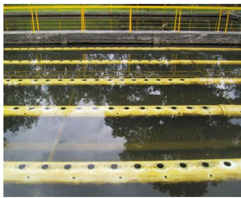
Figura 9: Foto de los tanques sedimentadores,
