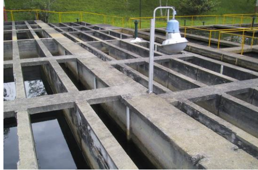
Figura 6: Cámaras de mezclado en la planta de tratamiento de El Tablazo.
