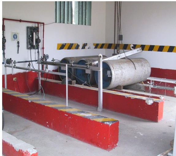
Figura 13: Cuarto de dosificación de cloro líquido almacenado en cilindros
