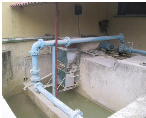
Figura 14: Dosificación de cal al agua filtrada mediante una tolva
