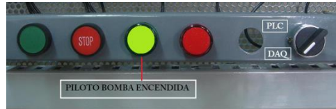
Figura 15: Piloto indicador de bomba encendida
